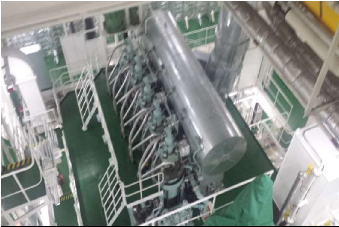
Ilustración 11 sala de máquinas. Fuente: Trabajo de campo.
