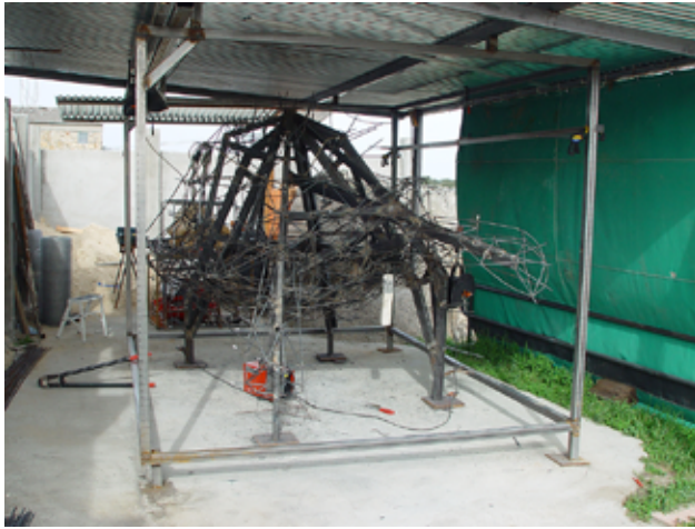
Fig. 13. Ana E. Balboa González, Fotografía de la estructura, proceso de soldado de las varillas de acero corrugado sobre la estructura portante , enero 2004, fotografía digital de 10 667 × 8000, archivo de Ana E. Balboa González, Madrid, España. Fuente: archivo personal.
