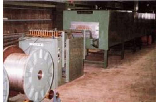
Ilustración n° 10. Horno para recocido de alambre de acero
