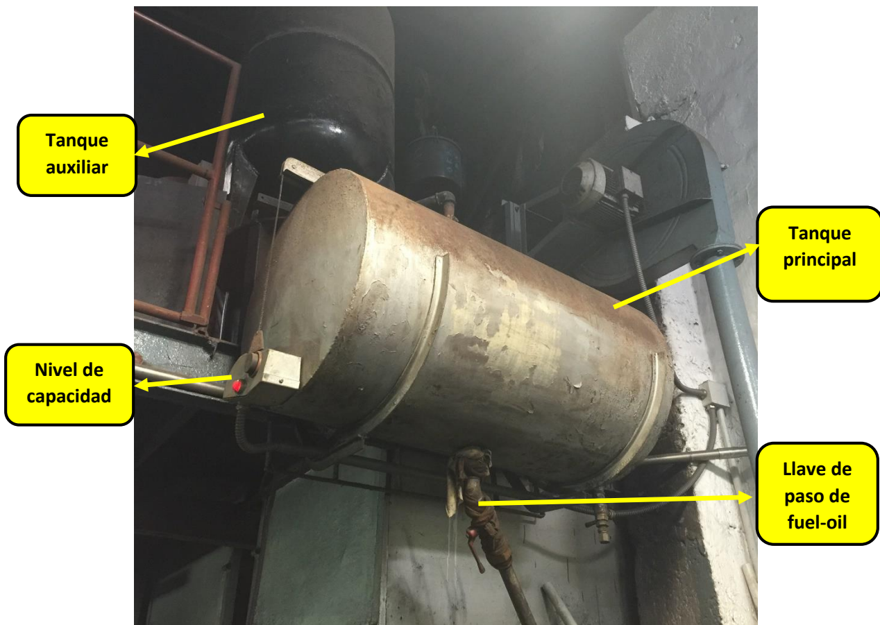
Ilustración n° 32. tanques de fuel-oil
