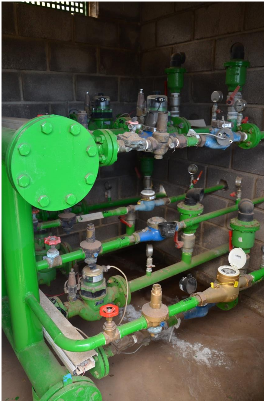
Figura 14. Hidrantes de la caseta 1. Caseta con más hidrante de la red (10)
