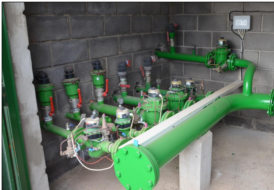
Figura 8. Hidrantes de una de las casetas de la red
