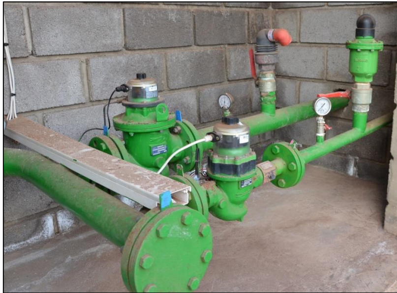
Figura 20. Elementos que componen un hidrante
