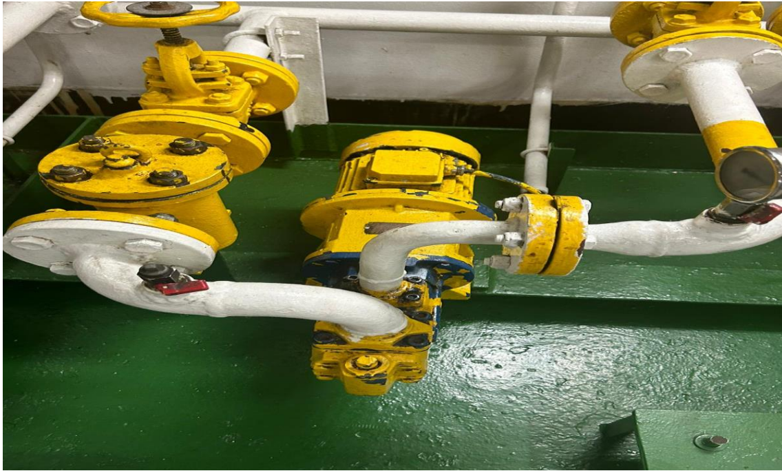
Ilustración 22. Bomba de alimentación de Aceite.
