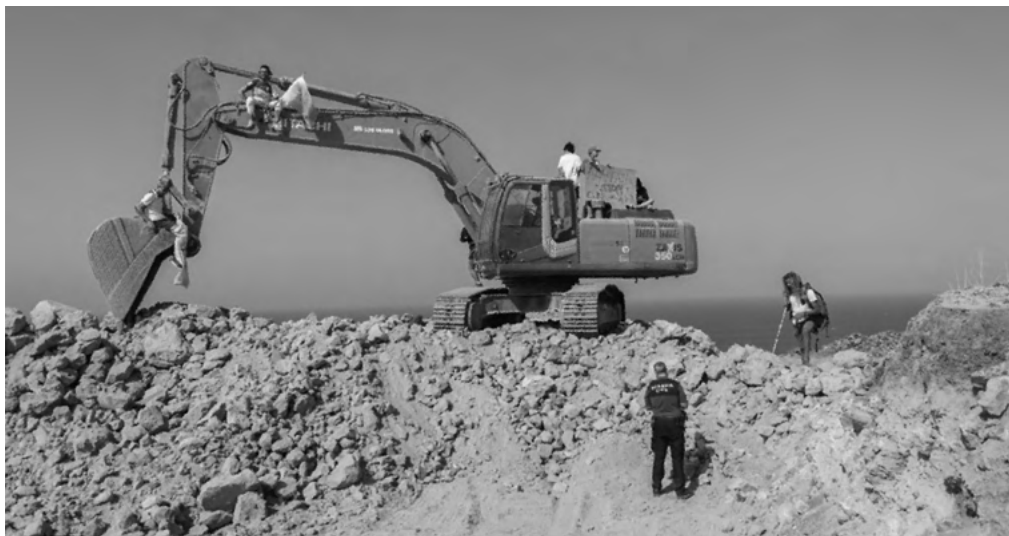
Activistas subidos en una de las palas de la construcción del hotel "Cuna del alma", 2022
