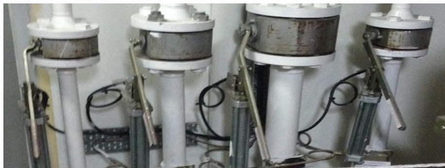
Ilustración29. Válvulas manuales de distribución. Fuente: Elaboración propia
