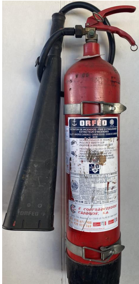
Ilustración40. Extintor portátil de dióxido de carbono. Fuente: Elaboración propia
