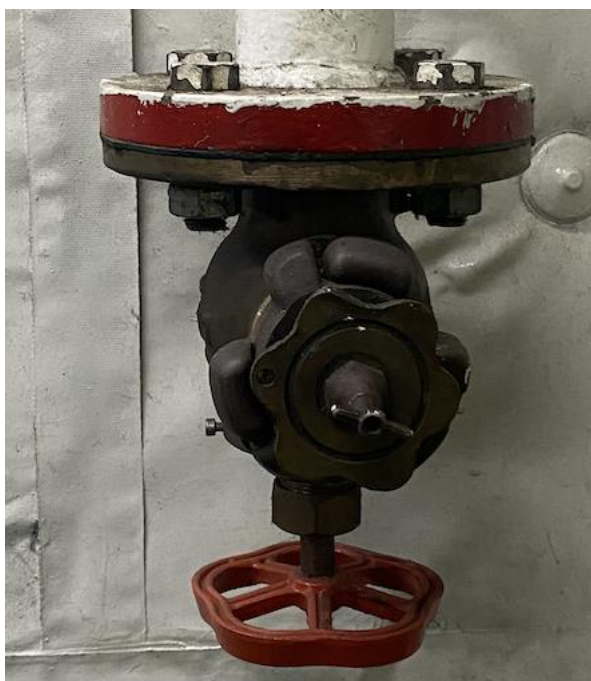
Ilustración22. Hidrante DN-50. Fuente: Elaboración propia
