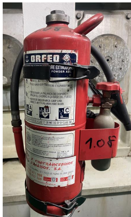
Ilustración39. Extintor portátil de polvo seco. Fuente: Elaboración propia
