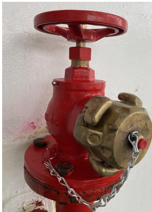
Ilustración21. Hidrante DN-65. Fuente: Elaboración propia
