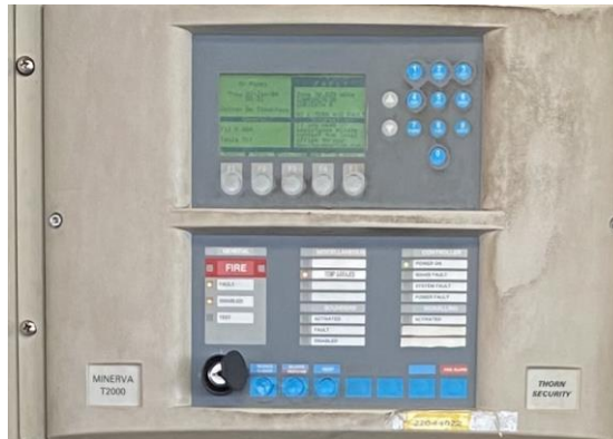
Ilustración6. Central contra incendios, Minerva T-2000. Fuente: Elaboración propia.
