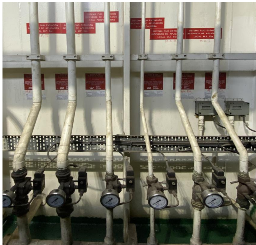
Ilustración35. Válvulas de control del sistema contra incendios fijo de aplicación local. Fuente: Elaboración propia
