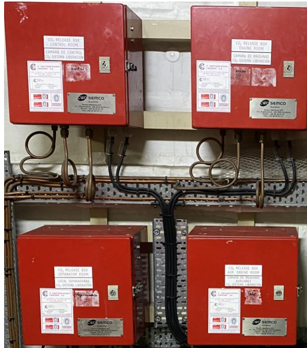
Ilustración28. Armarios de disparadores de locales. Fuente: Elaboración propia
