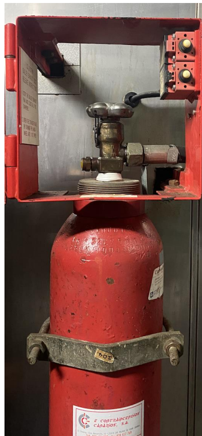
Ilustración32. Compartimento de disparo de dióxido de carbono para la campana de la cocina. Fuente: Elaboración propia
