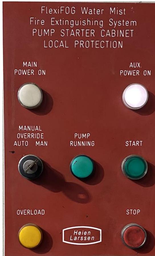
Ilustración36. Panel de control de la bomba del sistema contra incendios fijo de aplicación local. Fuente: Elaboración propia
