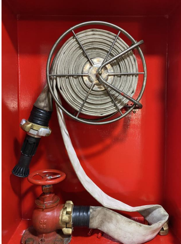
Ilustración20. Caja contra incendio. Fuente: Elaboración propia
