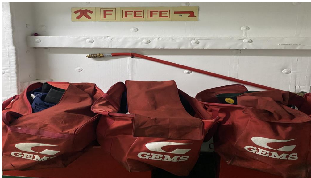
Ilustración47. Estación contra incendios. Fuente: Elaboración propia
