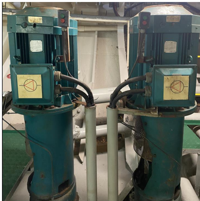
Ilustración 17. Bombas de rociadores de garaje. Fuente: Elaboración propia
