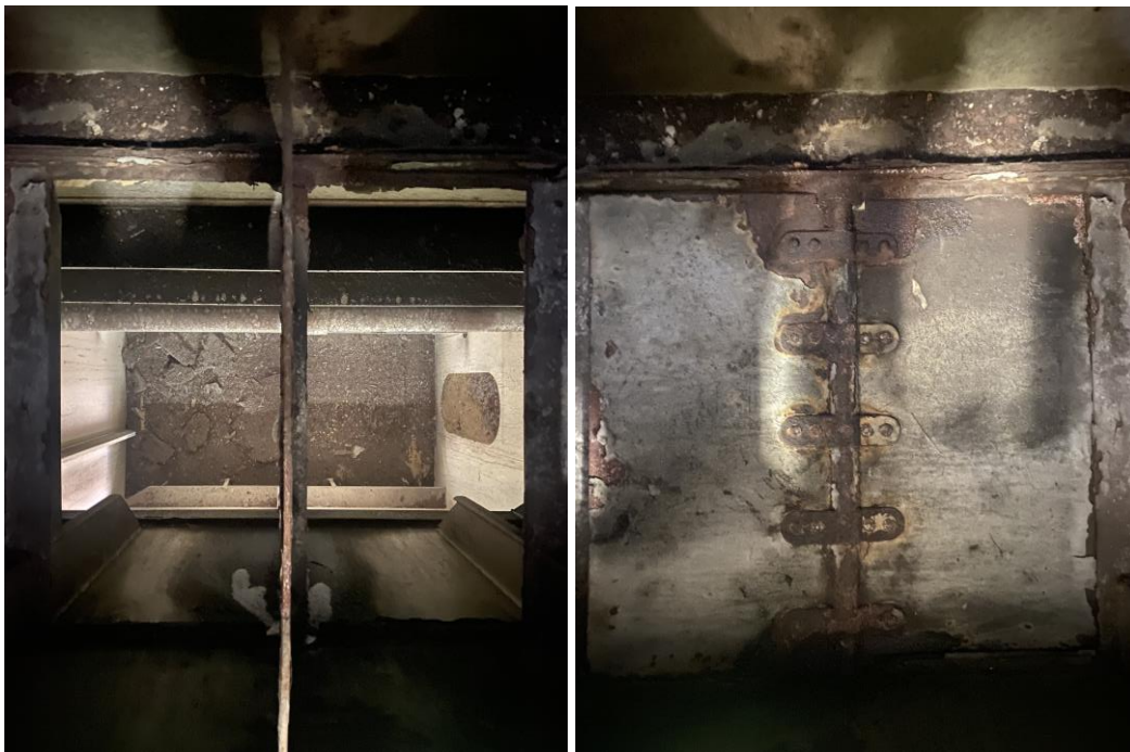
Ilustración46. Interior de un cierre de ventilación manual. Fuente: Elaboración propia
