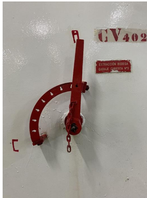
Ilustración45. Cierre de ventilación manual. Fuente: Elaboración propia
