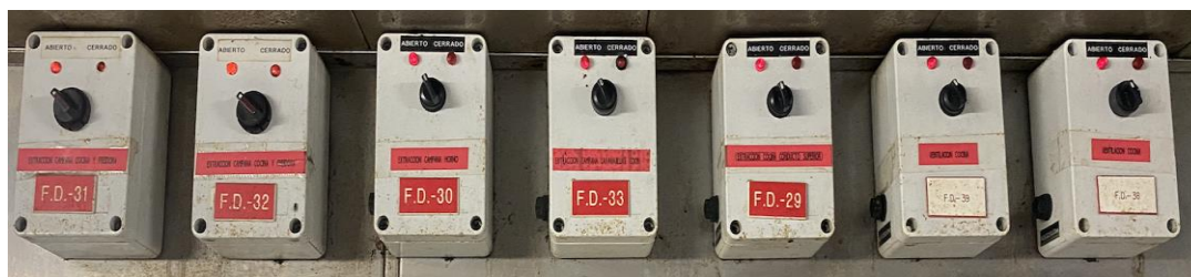
Ilustración44. Selectores de los fire dampers. Fuente: Elaboración propia
