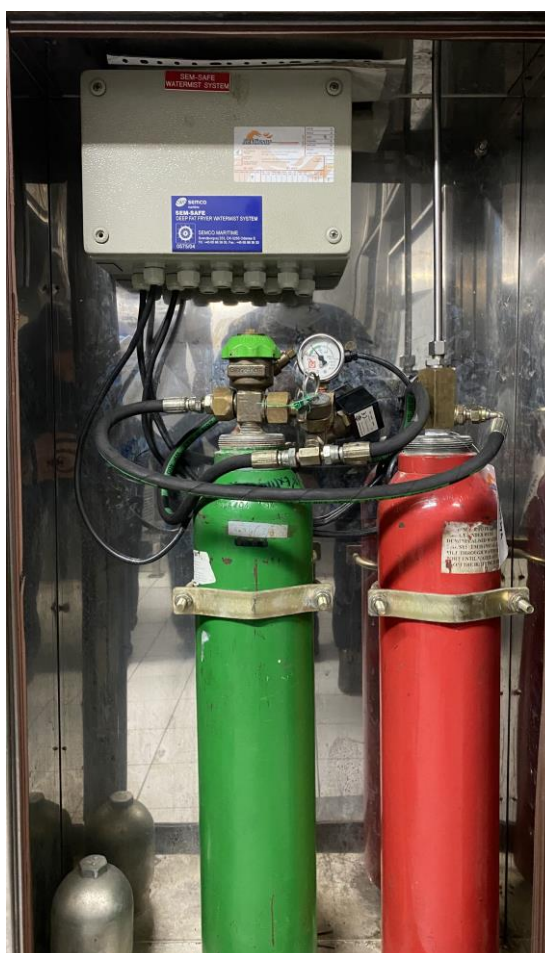
Ilustración37. Botellas del sistema de extinción de agua nebulizada para freidoras. Fuente: Elaboración propia
