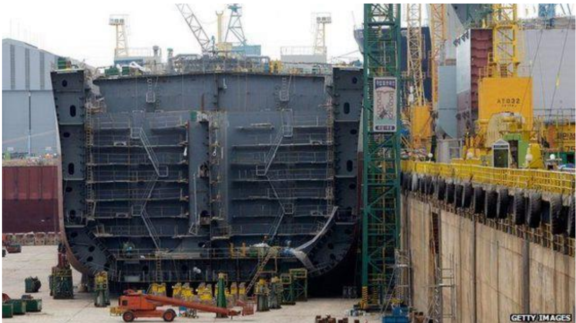
Ilustración 10. Ensamble de módulos en las gradas del astillero de Hyundai. Fuente: https://www.bbc.com/news/world-asia-32811866
