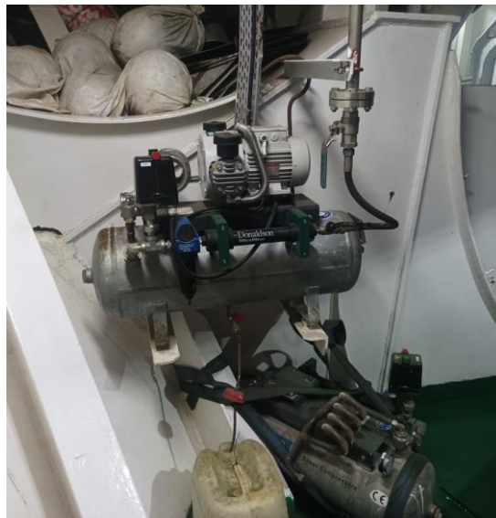
Figura 26. Compresor de aire de pilotaje. Fuente: Trabajo de campo.
