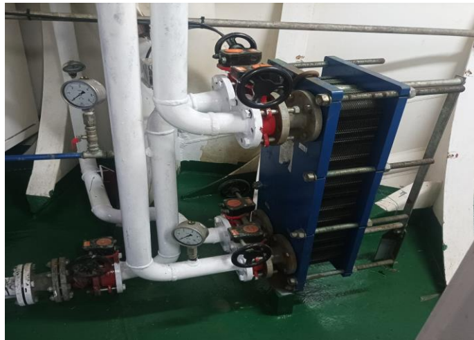
Figura 18. Enfriador de placas. Fuente: Trabajo de campo.
