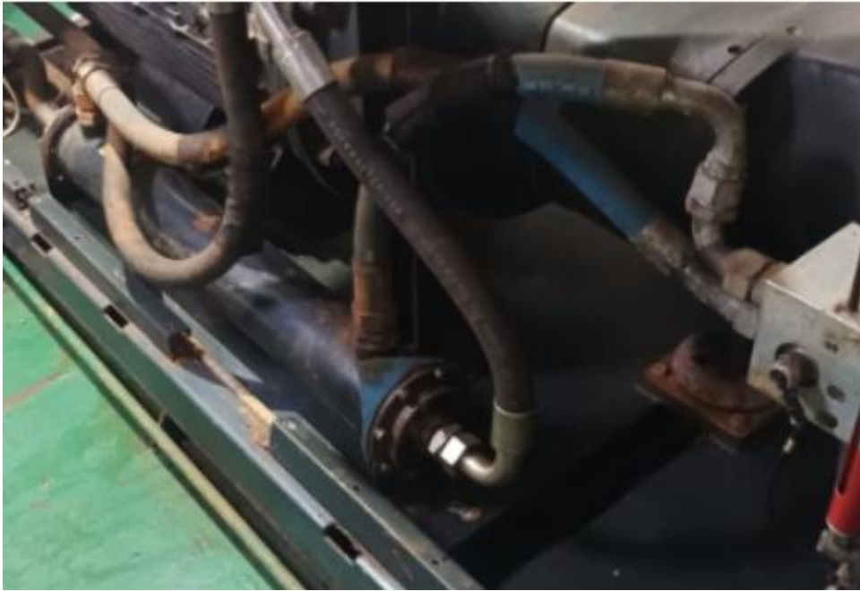
Figura 16. Enfriador tubular de aceite del compresor B. Fuente: Trabajo de campo.
