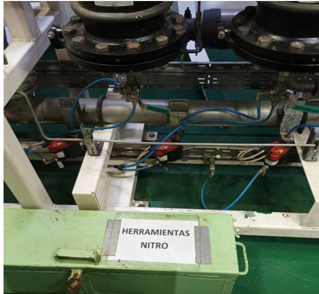
Figura 23. Purgadores de los filtros de partículas. Fuente: Trabajo de campo.
