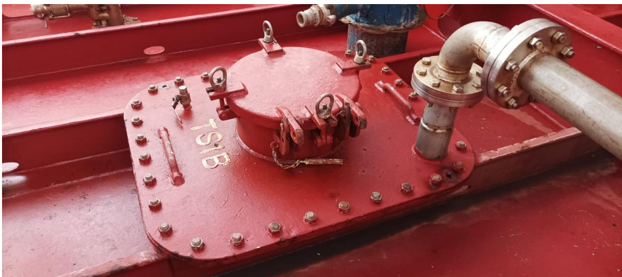
Figura 32. Tubería de gas inerte entrando a un tanque de carga. Fuente: Trabajo de campo
