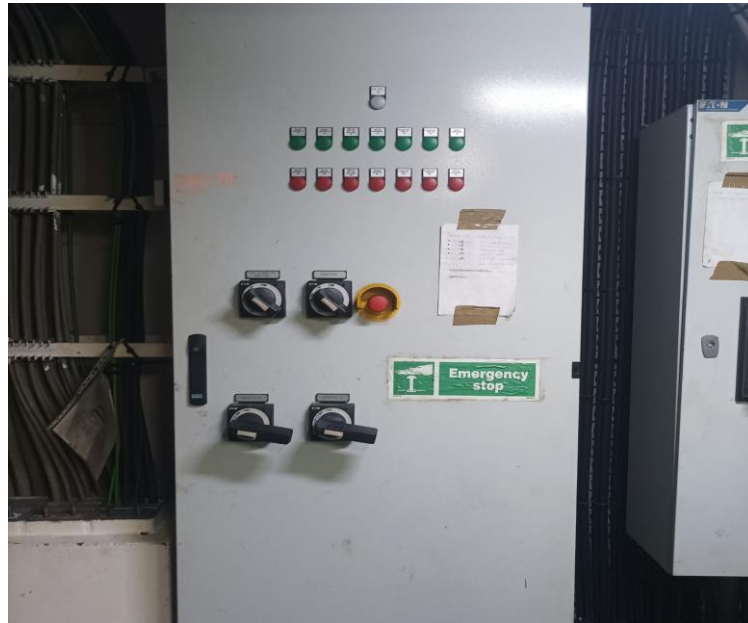
Figura 36. Cuadro de alimentación de la planta de gas inerte. Fuente: Trabajo de campo
