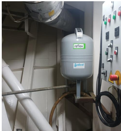
Figura 20. Tanque de compensación de presión. Fuente: Trabajo de campo
