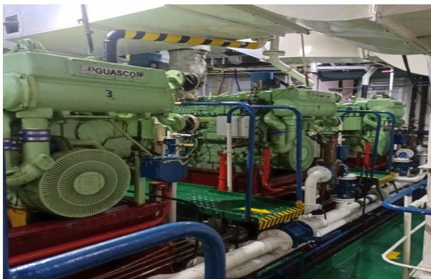
Figura 10. Motores auxiliares. Fuente: Trabajo de campo.
