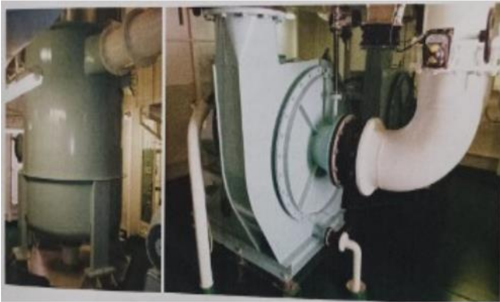
Figura 3. Ventiladores de gas inerte. Fuente (Louzán Lago, 2020).
