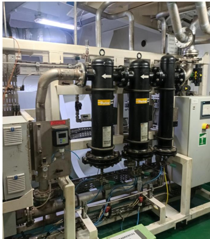
Figura 22. Bloque de filtros. Fuente: Trabajo de campo
