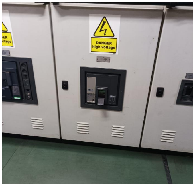
Figura 34. Seccionador directo de barras a hélice de proa. Fuente: Trabajo de campo.
