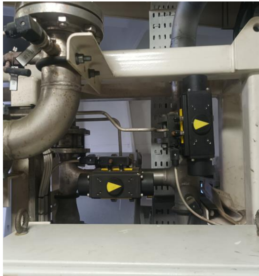
Figura 25. Válvulas de interconexión entre membranas y bypass. Fuente: Trabajo de campo.
