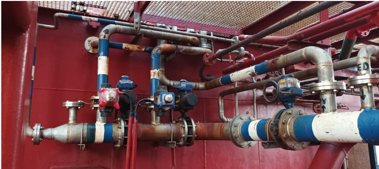
Figura 31. Colector de la línea de cubierta. Fuente: Trabajo de campo.
