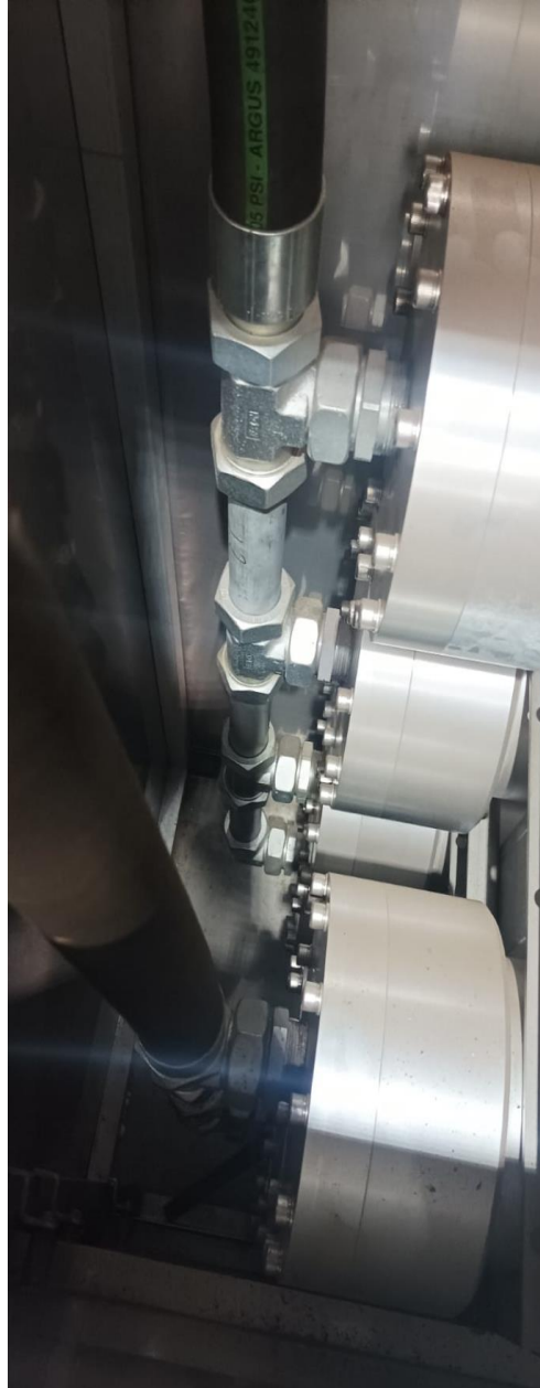
Figura 28. Contenedores de las membranas en paralelo. Fuente: Trabajo de campo
