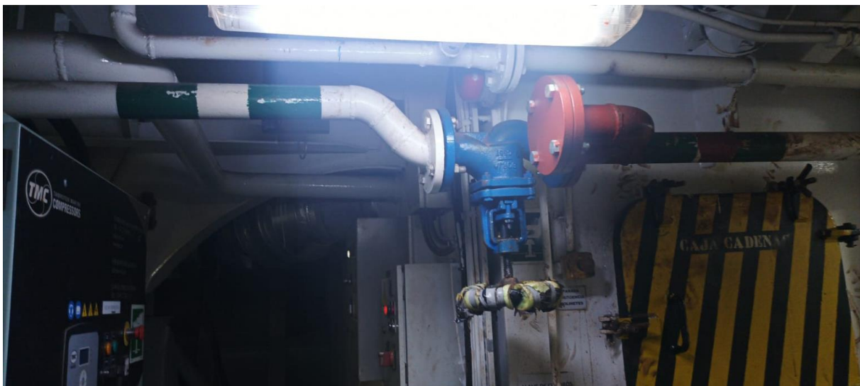
Figura 17. Válvula de apertura de agua salada al compresor A. Fuente: Trabajo de campo.
