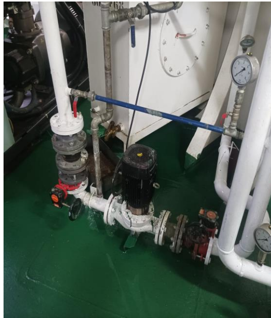
Figura 19. Bomba de agua dulce a enfriadores. Fuente: Trabajo de campo
