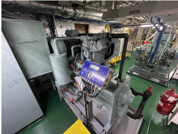
Figura 4.1: Compresor y motor eléctrico Fuente:Elaboración propia
