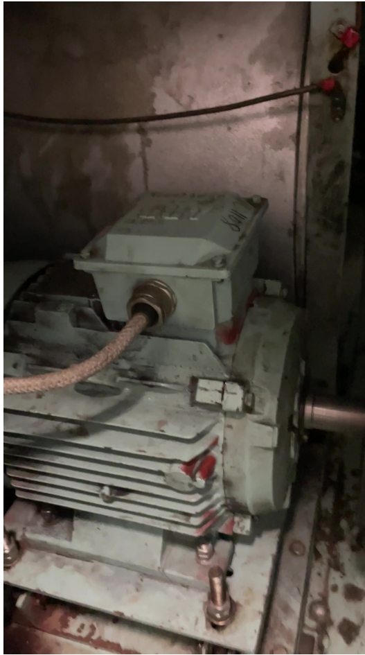
Figura 1.9: Motor acoplado al ventilador Fuente:Elaboración propia
