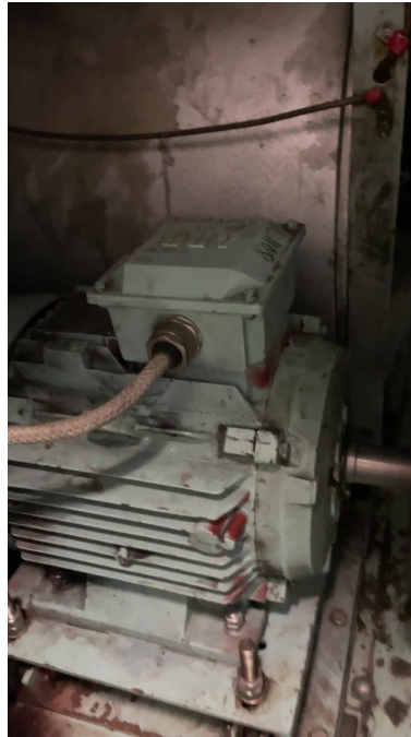
Figura 4.2: Motor del ventilador en el climatizador Fuente:Elaboración propia
