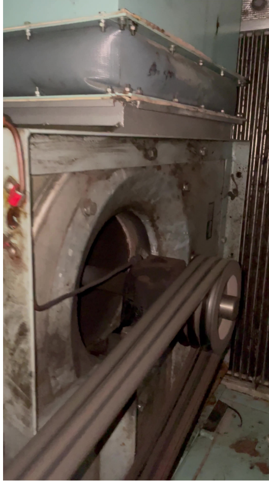
Figura 1.8: Ventilador dentro del climatizador Fuente:Elaboración propia
