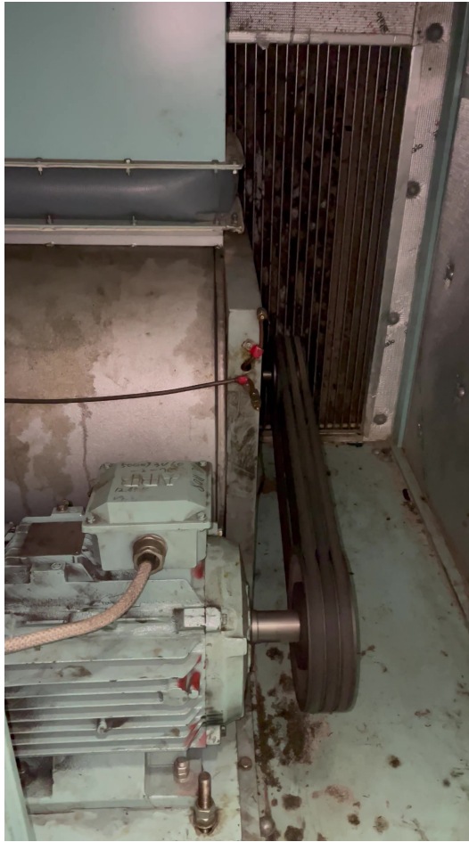
Figura 1.7: Intercambiador de calor del climatizador Fuente:Elaboración propia
