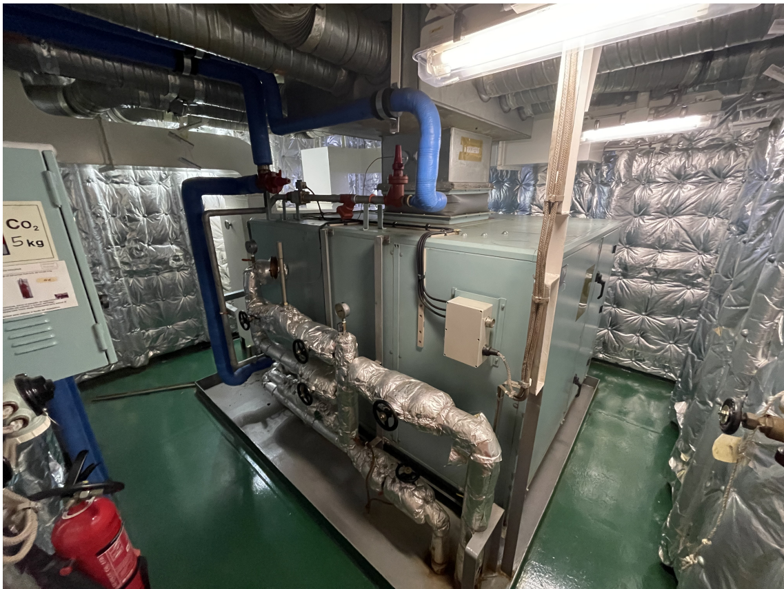
Figura A.1: Parte del ventilador del climatizador Fuente:Elaboración propia
