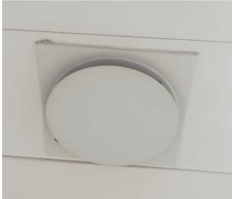
Figura 3.1: Ventilaciones cilíndricas de acomodación. Fuente:Fernández X Fotografía; año 2021; Buque Mencey
