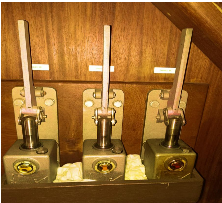
Ilustración 13. Palancas de corte de suministro. Fuente: Trabajo de campo.
