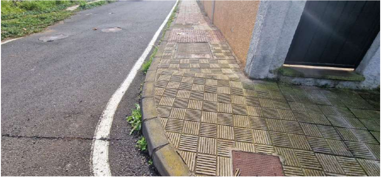
Imagen 15. Acometidas eléctricas y de abastecimiento Calle el Fresno, frente a zonas ajardinadas.
