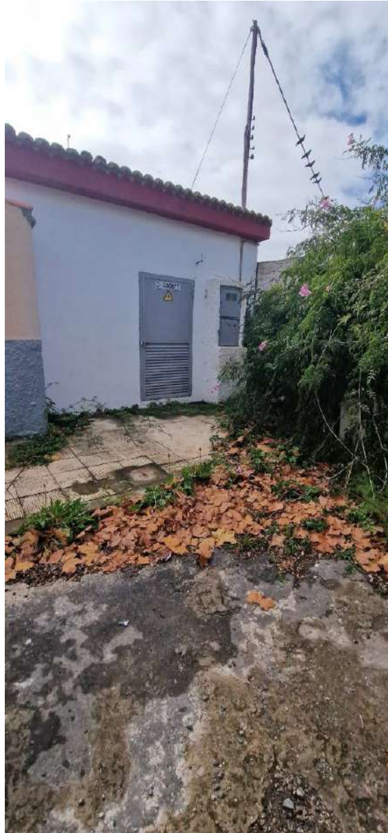
Imagen 7. Estación transformadora al final de la Calle el Fresno (calle sin salida).
