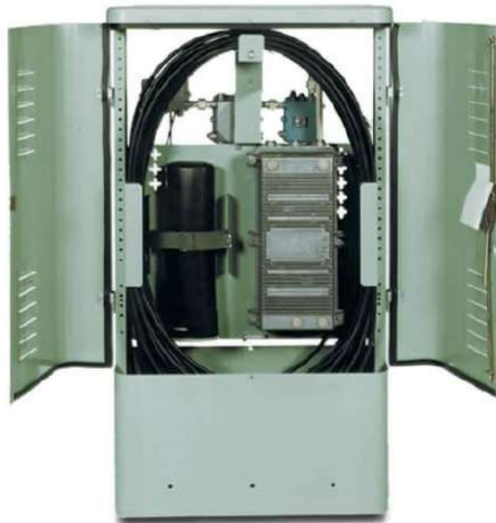
Imagen 1. Ejemplo de pedestal de telecomunicaciones.
