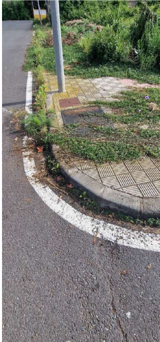
Imagen 18. Arquetas baja tensión zona ajardinada Calle el Fresno.
