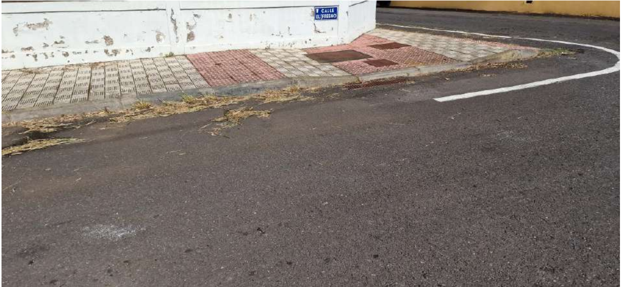
Imagen 13. Arquetas eléctricas e imbornal de pluviales Calle el Fresno.
