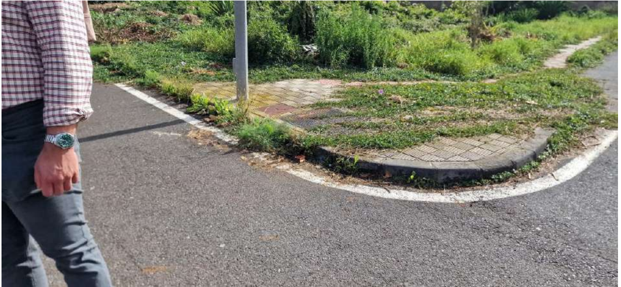
Imagen 17. Arquetas baja tensión zona ajardinada Calle el Fresno.
