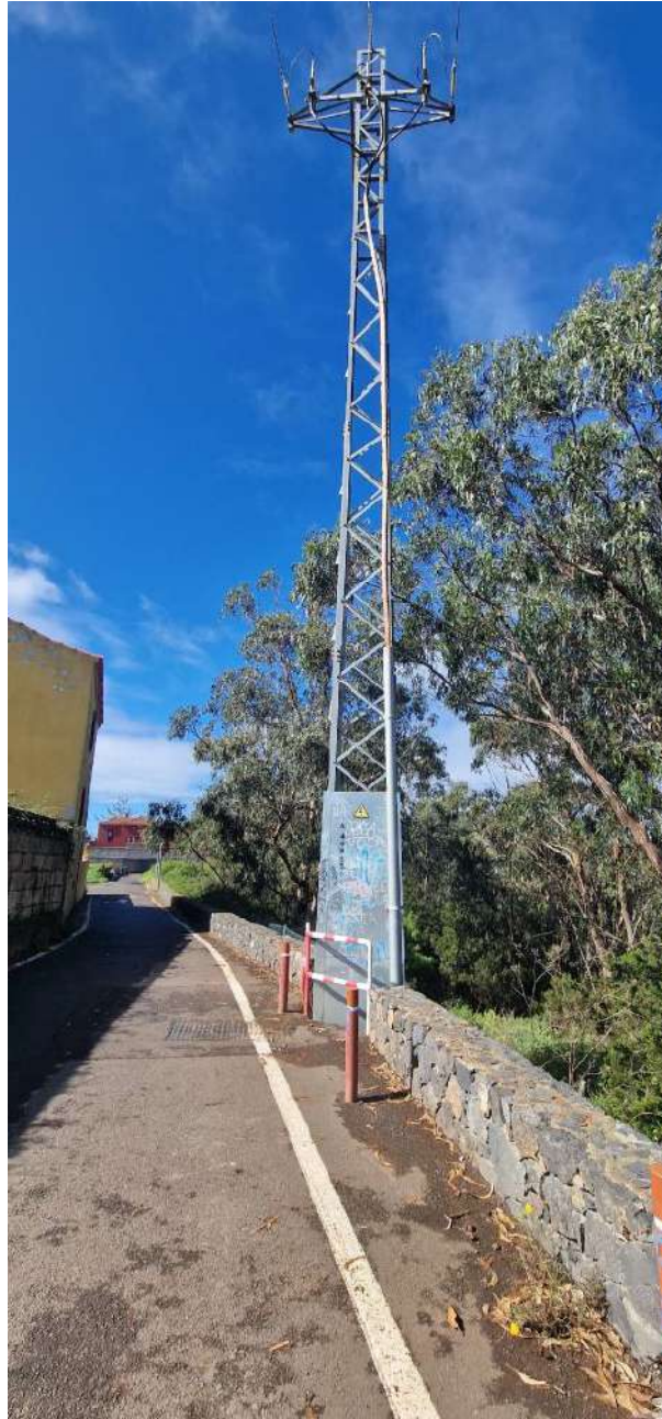
Imagen 6. Torre eléctrica de media tensión a un lateral de la Calle Padilla Alta.
