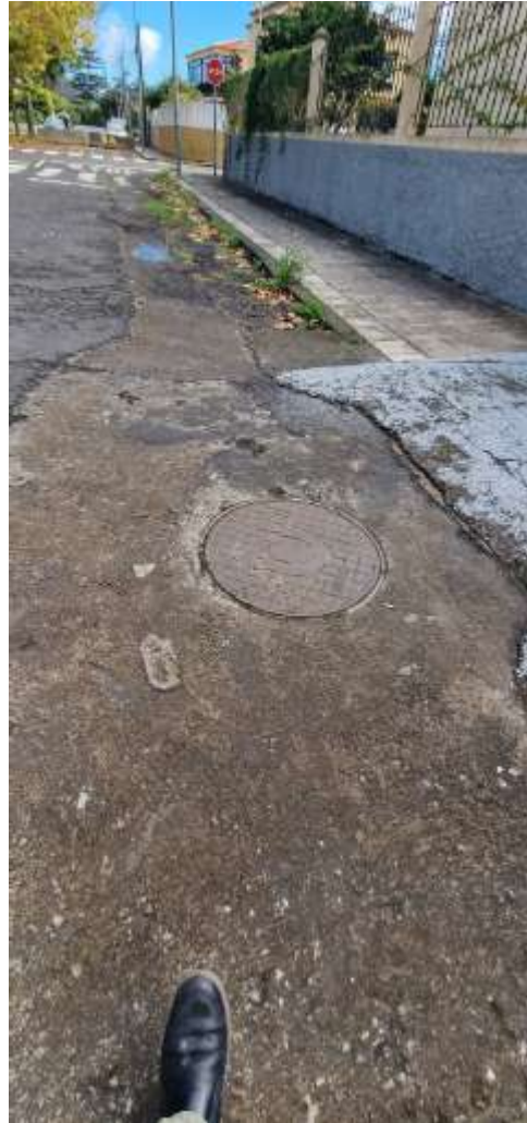
Imagen 8. Arqueta eléctrica de Unelco frente a la estación transformadora.
