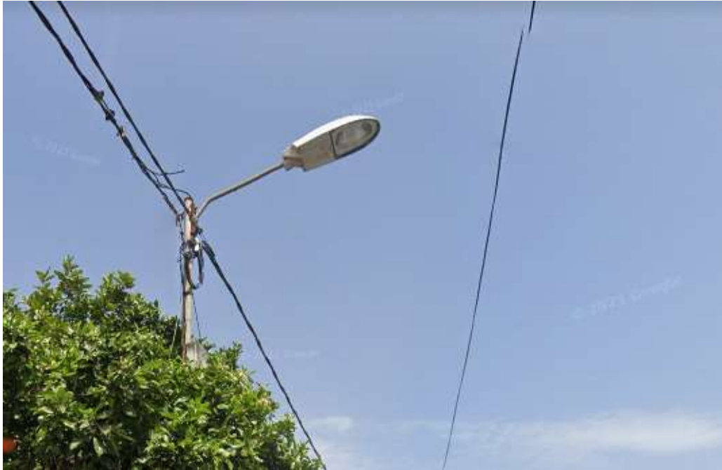
Imagen 4. Luminaria existente (c/ Canónigo Leopoldo Morales y calle Vereda del Camellón). Fuente: Google Street View.
