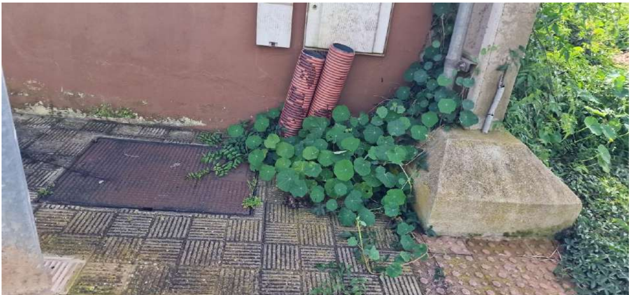
Imagen 14. Arqueta de baja tensión Calle el Fresno.
