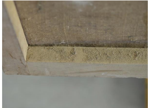
Figura 81.- Detalle de la suciedad acumulada y cantos sin biselar.
