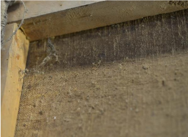
Figura 80.- Detalle de la suciedad acumulada y cantos sin biselar.
