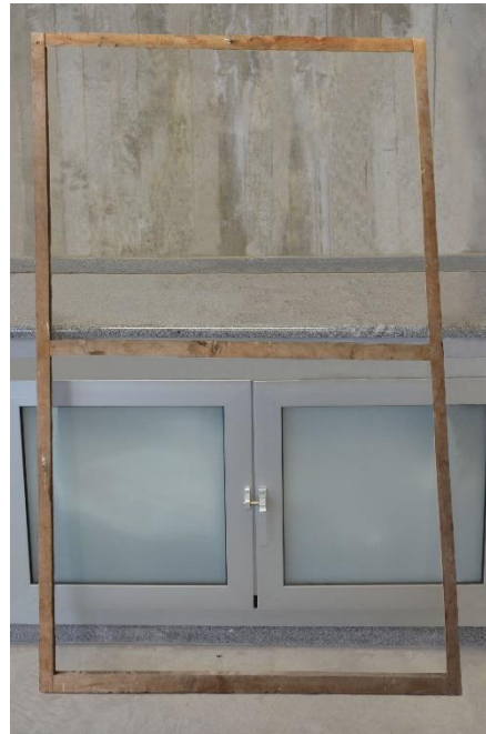
Figura 83.- Lado del bastidor deformado.
