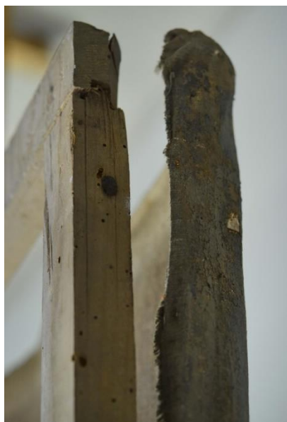
Figura 76.- Detalla de zona sin anclaje al bastidor.
