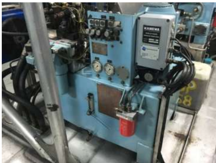
Ilustración 27: Unidad de potencia hidráulica
