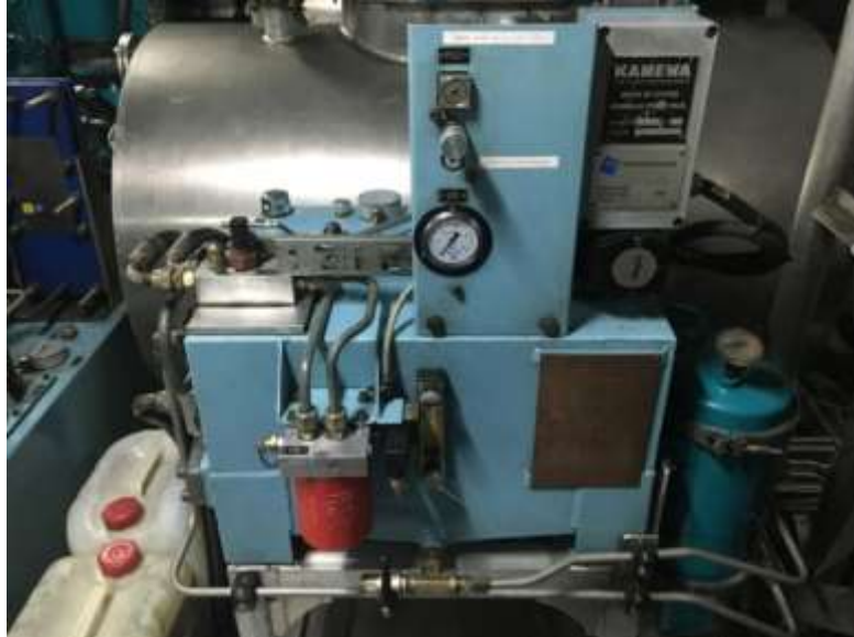
Ilustración 26: Unidad de potencia de lubricación.
