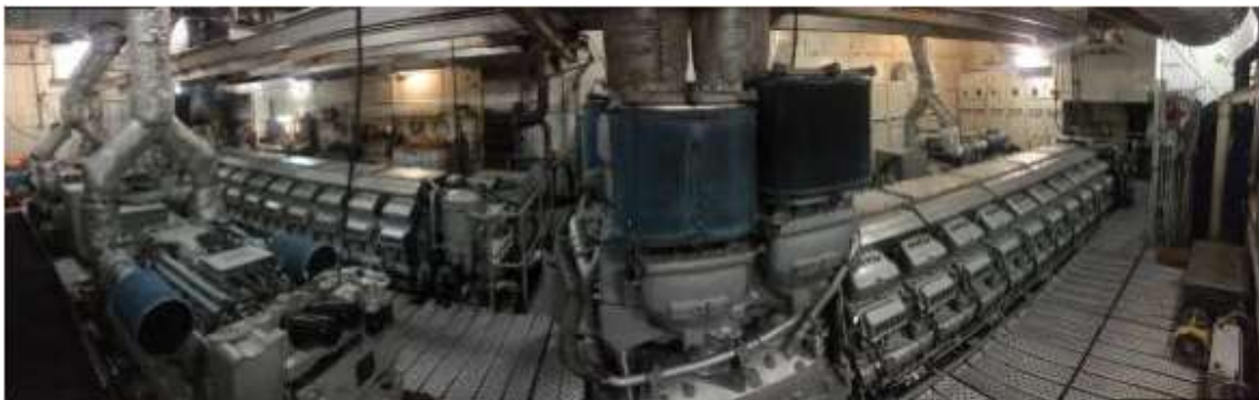
Ilustración 9: Sala de máquinas de proa del Benchijigua
