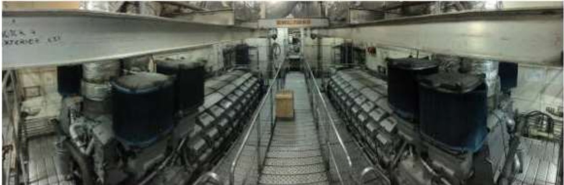
Ilustración 8: Sala de máquina de popa del Benchijigua
