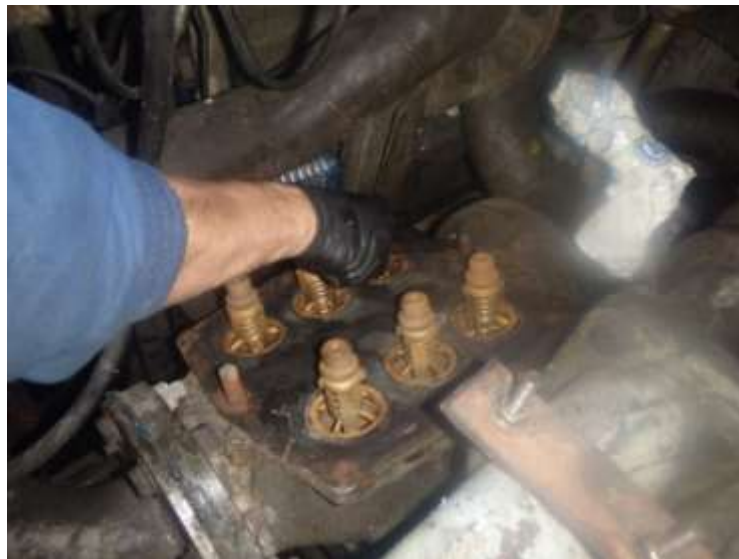
Ilustración 77: Limpieza válvula termostática
