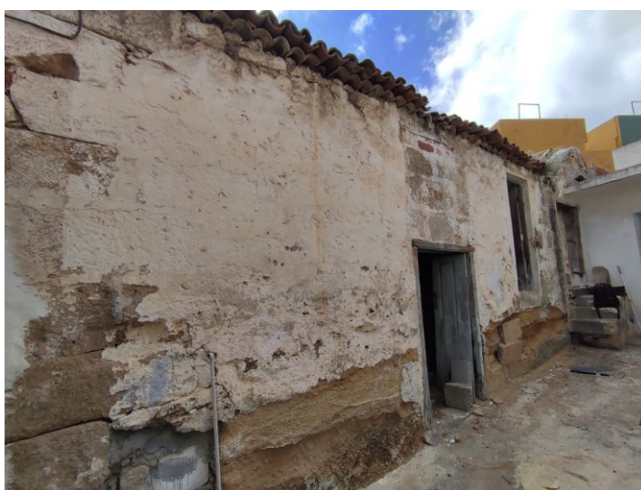
Figura 8. Deterioro en el arranque de los muros. Fuente: elaboración propia
