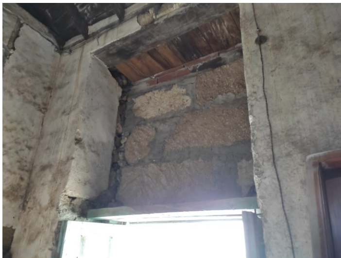
Figura 9. Vista interior del dintel originado por la modificación del nivel. Fuente: elaboración propia.
