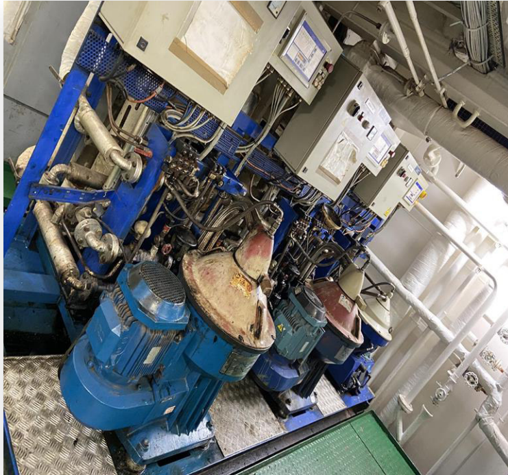
Ilustración 10: Depuradoras de combustible Fuente: Trabajo de campo
