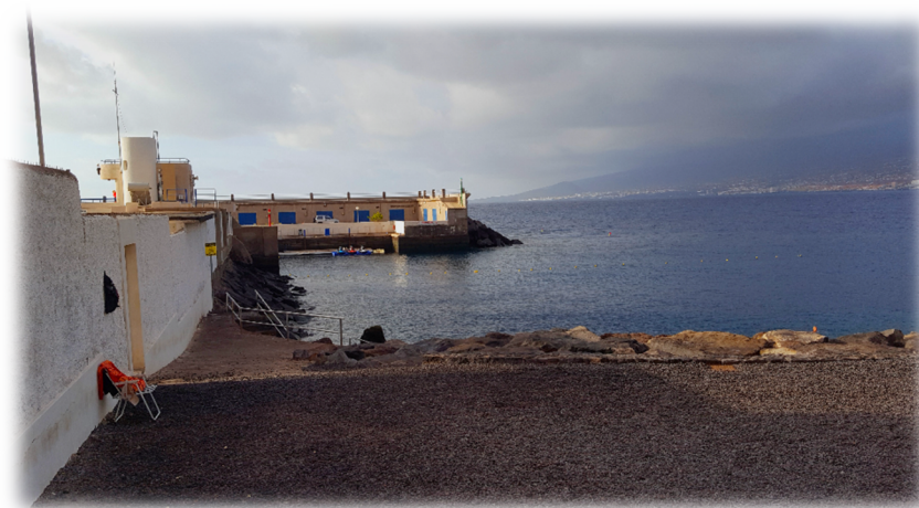
Figura 8. Aliviadero EBAR Puertito de Radazul. GRAFCAN-Visor IDECanarias
