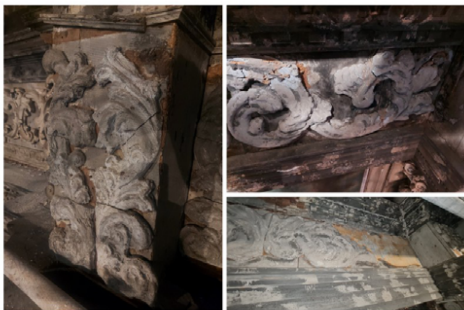
Fig. 2. Aspecto de algunos elementos del retablo que habían sido añadidos.
