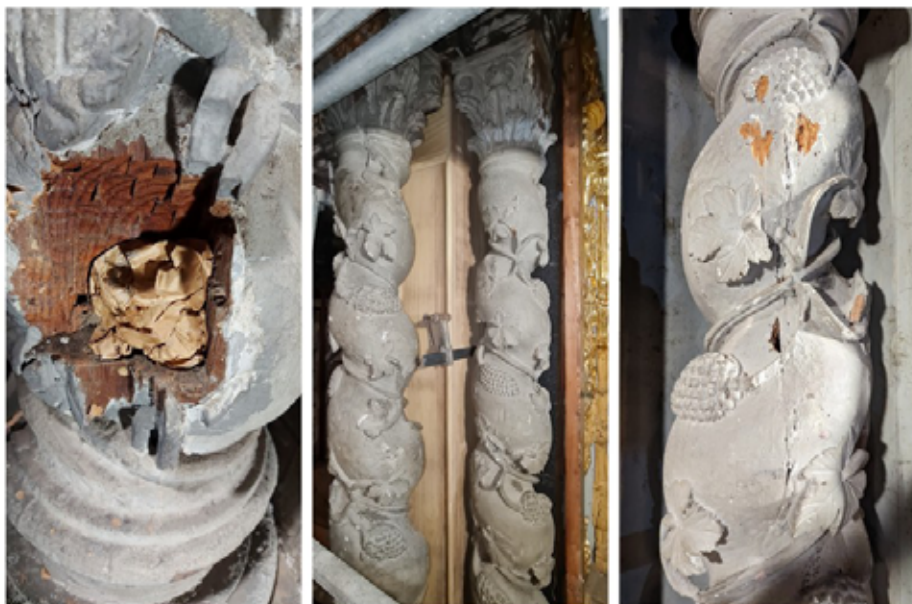
Fig. 5. Estado de algunas columnas e intervención para reforzar la estructura.
