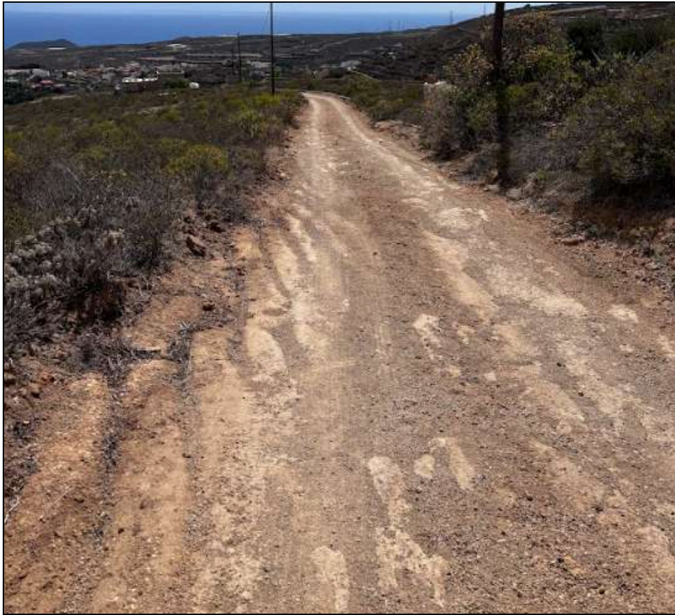
Imagen 3. Tramo inicial del Camino Transversal Las Eritas en estado de deterioro.
