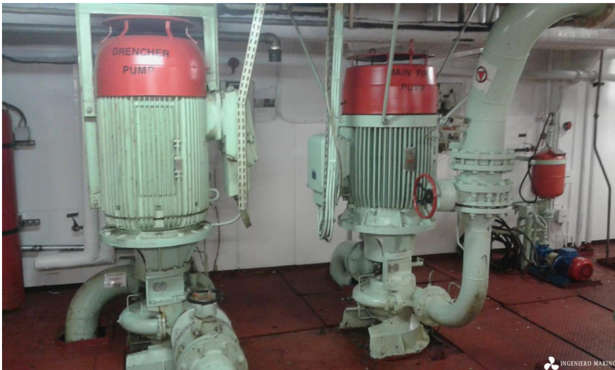
Ilustración 11. Bombas contra incendios. Fuente: ingenieromarino.com.
