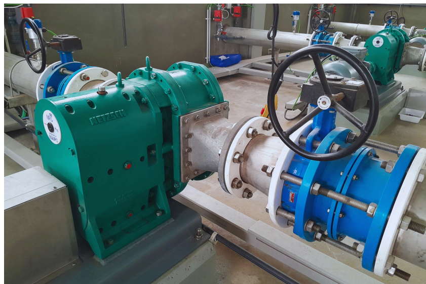
Tuberías EDAR Nordeste / Lorena Rodríguez
