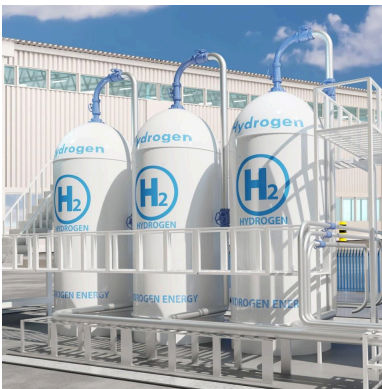
Ilustración 8: Tanque de almacenamiento de hidrógeno. Fuente: Empresa Ariema.
