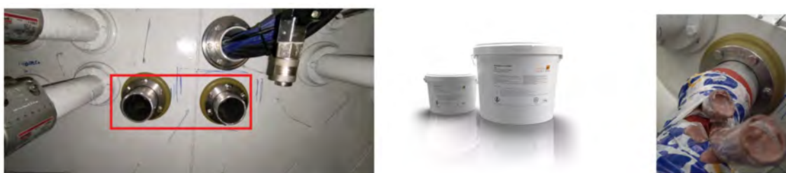
Figura 30: Sellado pasamuros (Fuente: Trabajo de campo)
