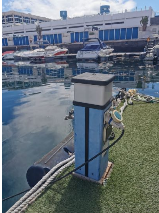
Ilustración 3. Torreta de abastecimiento de agua y electricidad.
