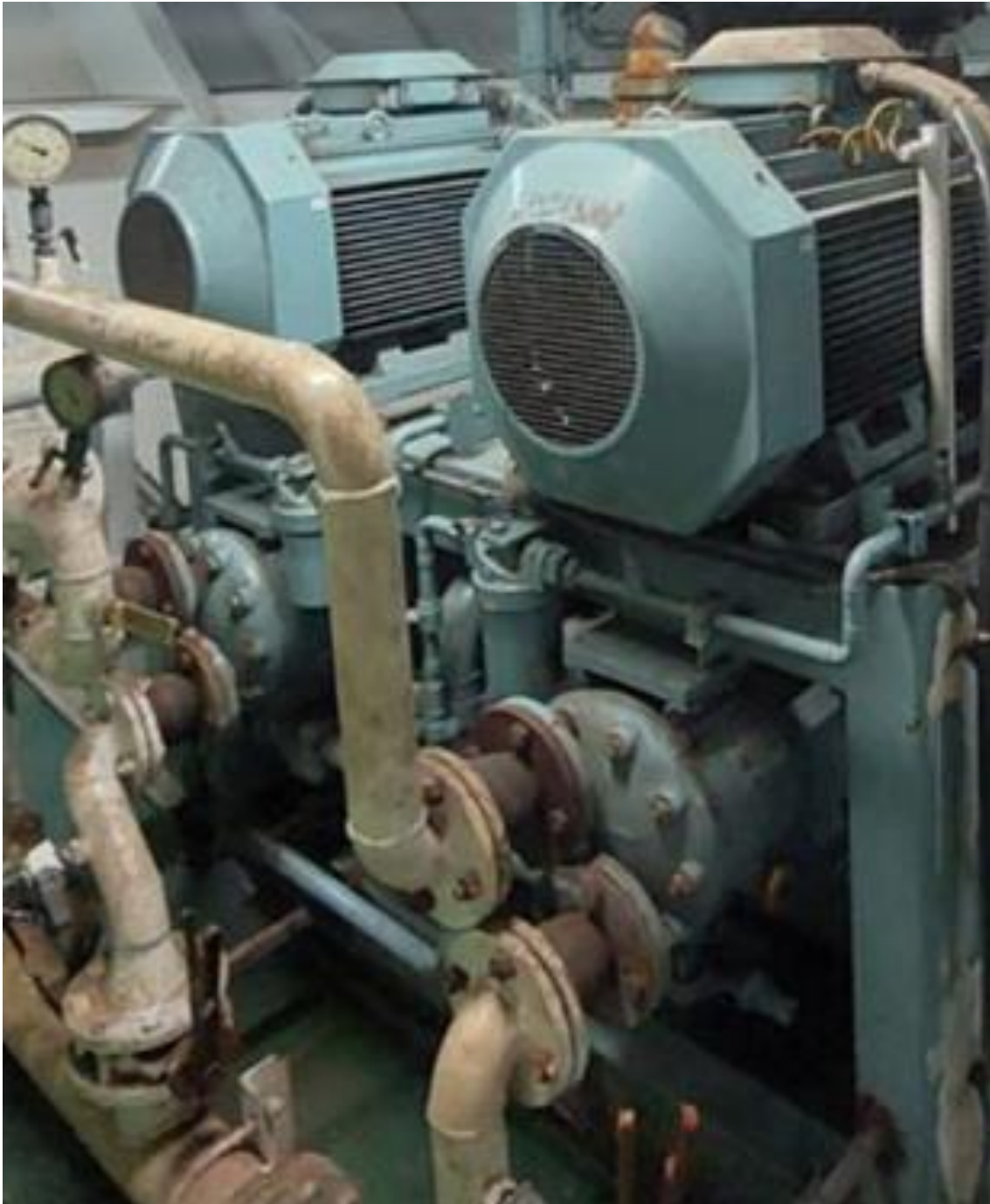
Ilustración 7. Compresores del sistema de aire acondicionado. Fuente: Elaboración propia.
