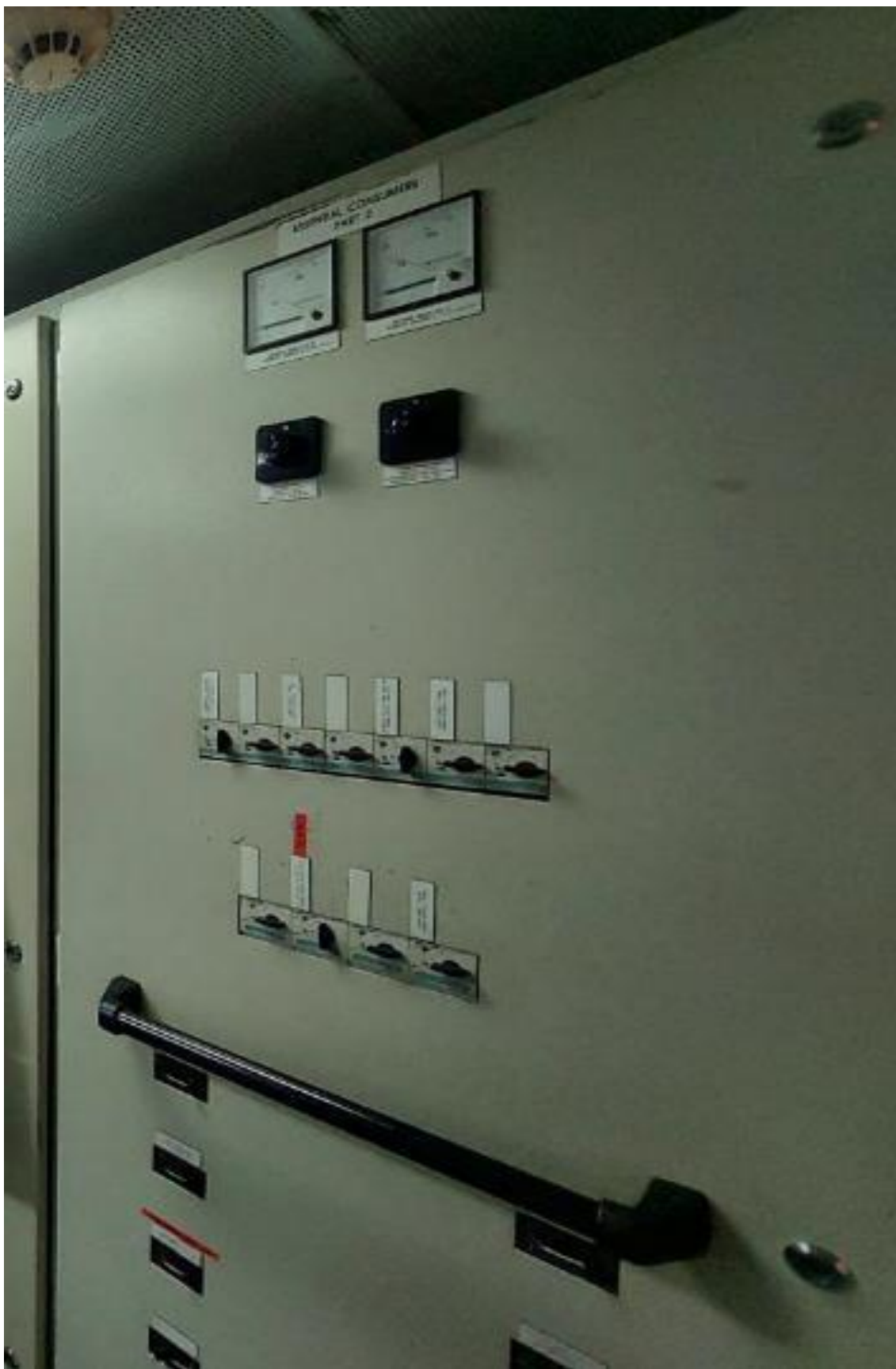
Ilustración 20. Cuadro eléctrico de consumos esenciales Nº 2 en el Control Room. Fuente: Elaboración propia.
