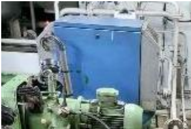
Ilustración 51. Secador de aire en la sala de máquinas. Fuente: Elaboración propia.
