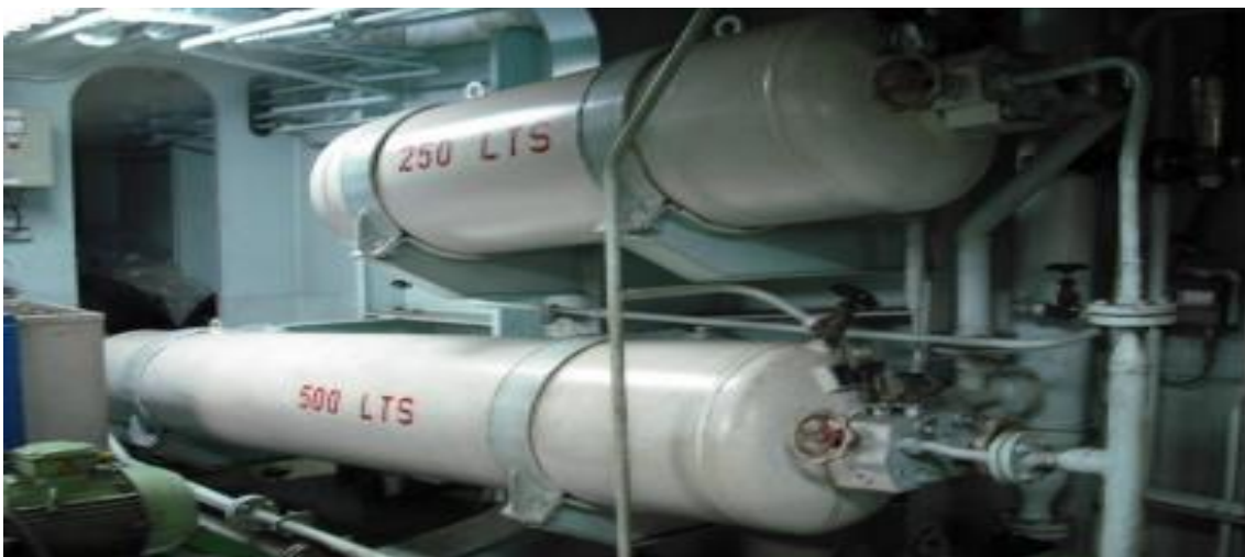
Ilustración 50. Botellas de aire comprimido de arranque en la sala de máquinas del buque. Fuente: Elaboración propia.
