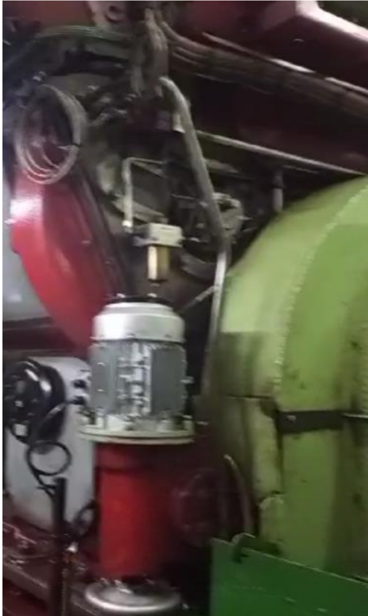
Ilustración 62. Virador del motor principal (tecle inferior). Fuente: Elaboración propia.
