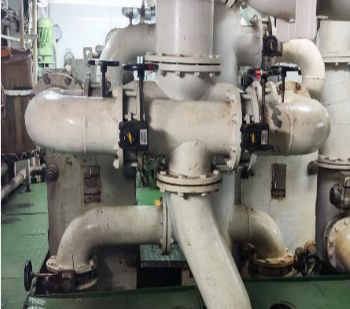
Ilustración 31. Enfriadores de LT/SW en el cuarto de bombas. Fuente: Elaboración propia.
