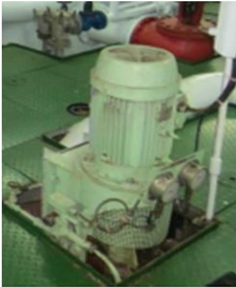
Ilustración 39. Bomba de puerto de agua salada en el cuarto de bombas. Fuente: Elaboración propia.
