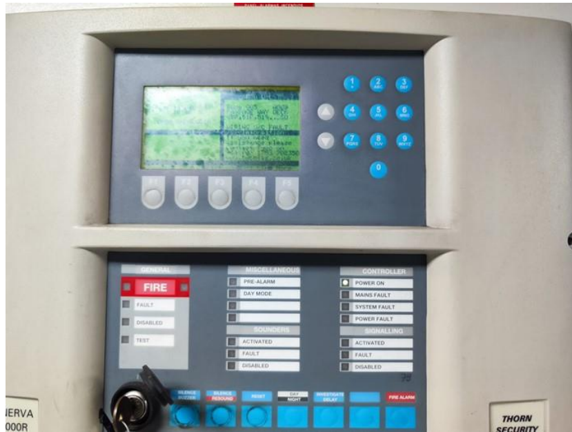
Ilustración 26. Monitor repetidor de alarmas del sistema contraincendios del buque. Fuente: Elaboración propia.
