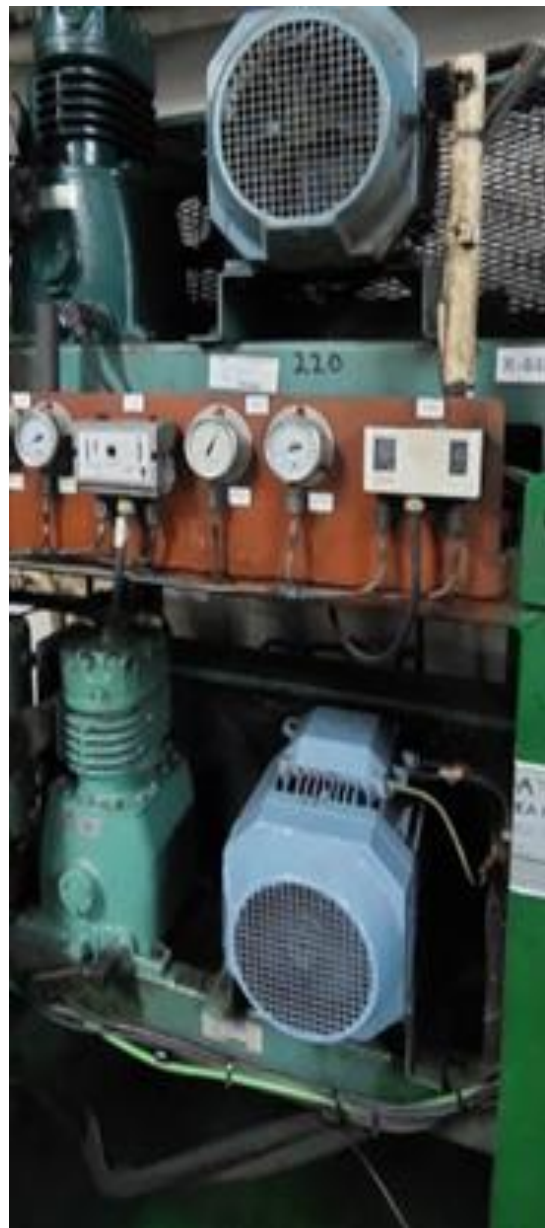
Ilustración 5. Compresores 1 y 2 de las cámaras frigoríficas (una de refrigeración y otra de congelación). Fuente: Elaboración propia.
