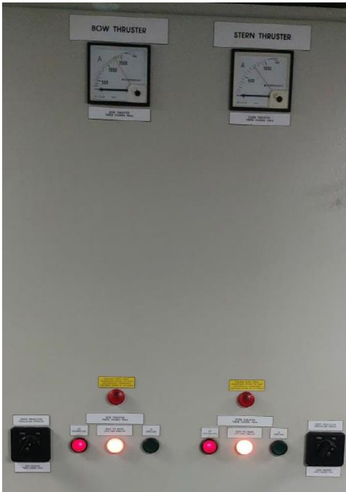
Ilustración 21. Cuadro eléctrico de alimentación de las hélices transversales de proa y popa en el Control Room. Fuente: Elaboración propia.
