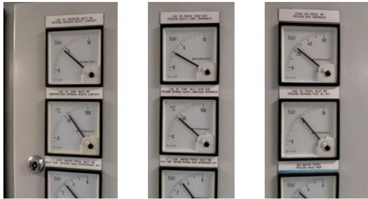
Ilustración 11. Las 3 imágenes componen el cuadro de sistemas del motor principal del buque en el Control Room. Fuente: Elaboración propia.
