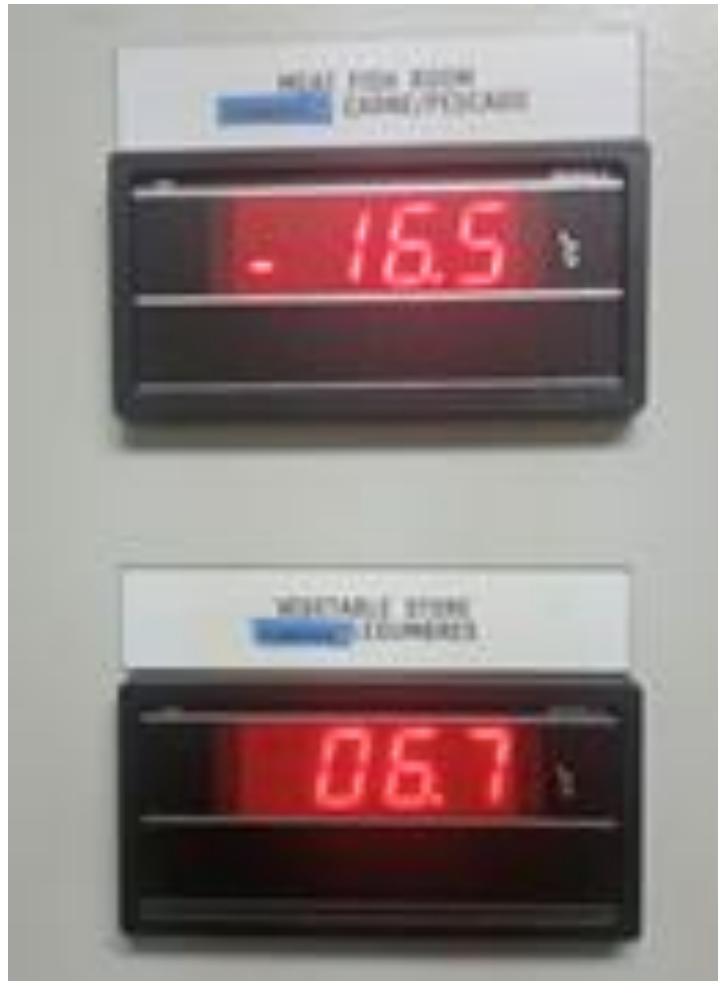
Ilustración 6. Control de parámetros de las cámaras frigoríficas desde el Control Room. Fuente: Elaboración propia.
