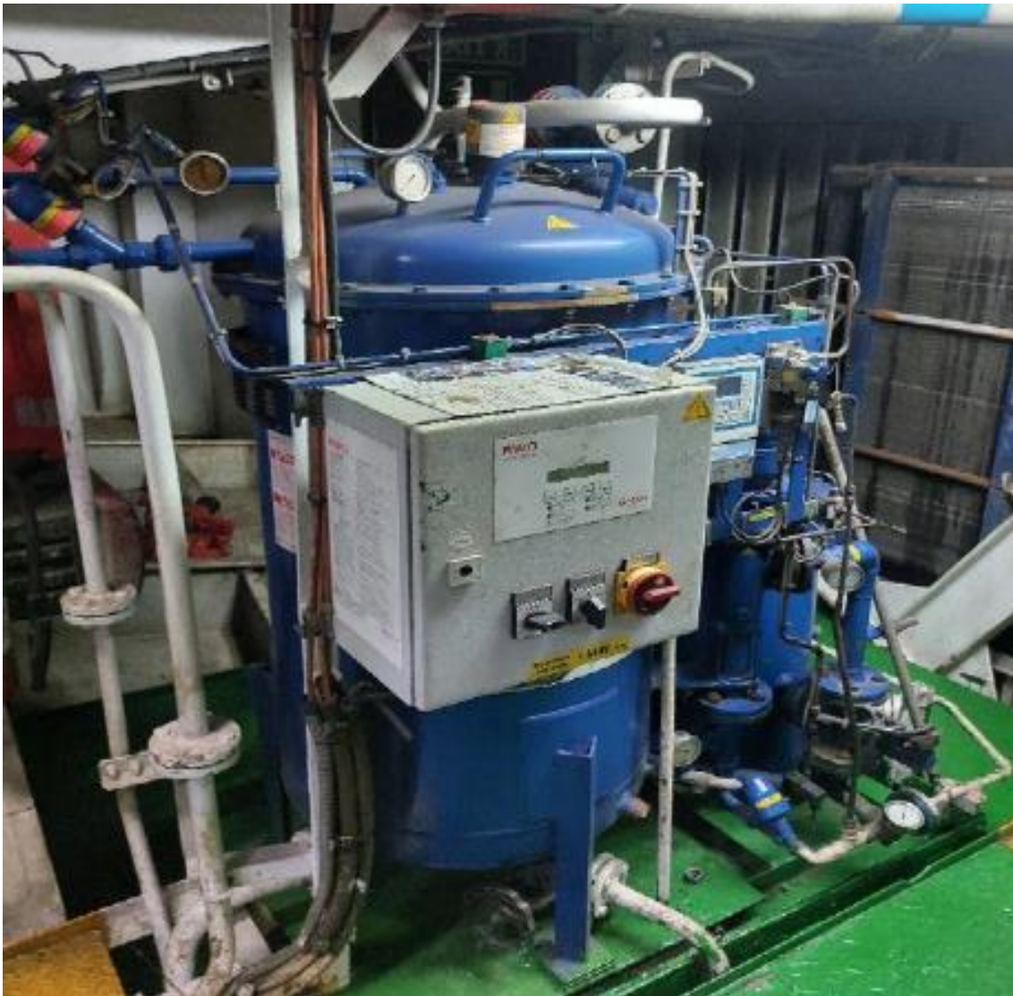
Ilustración 64. Separador de aguas de sentina ubicado en la sala de máquinas (tecle inferior). Fuente: Elaboración propia.
