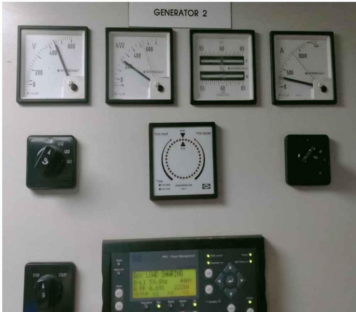
Ilustración 13. Cuadro de acople con sistema de control de generador auxiliar Nº2. Fuente: Elaboración propia.
