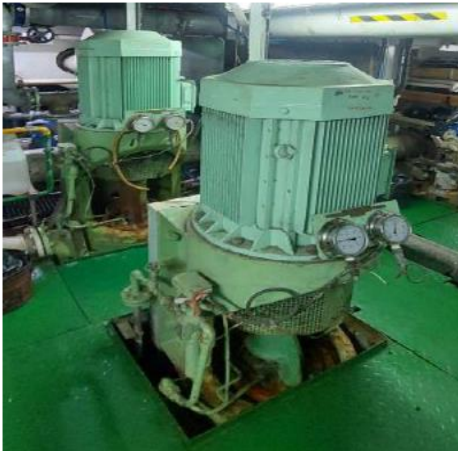
Ilustración 38. Bombas de agua salada en el cuarto de bombas. Fuente: Elaboración propia.
