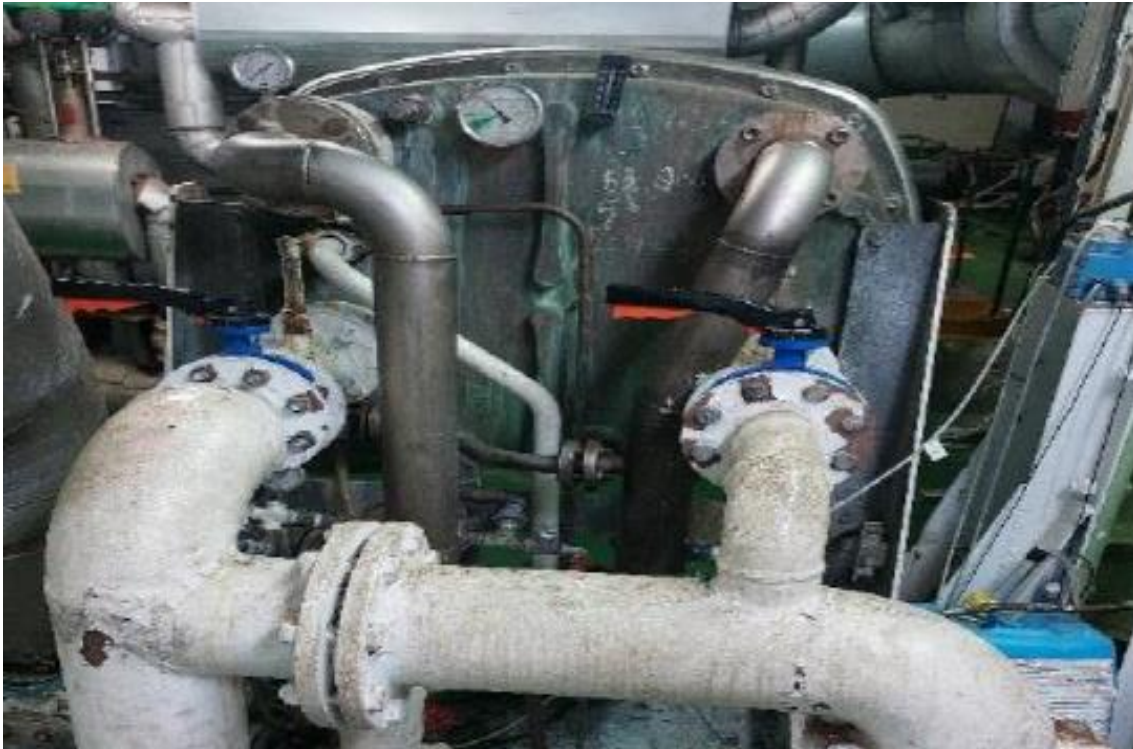
Ilustración 46. Evaporador en la sala de máquinas del buque. Fuente: Elaboración propia.
