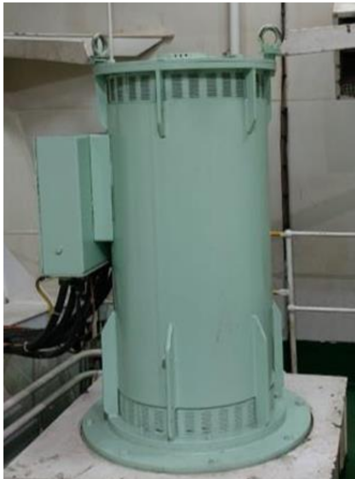
Ilustración 3. Motor eléctrico de la hélice de proa en el local técnico de proa. Fuente: Elaboración propia.
