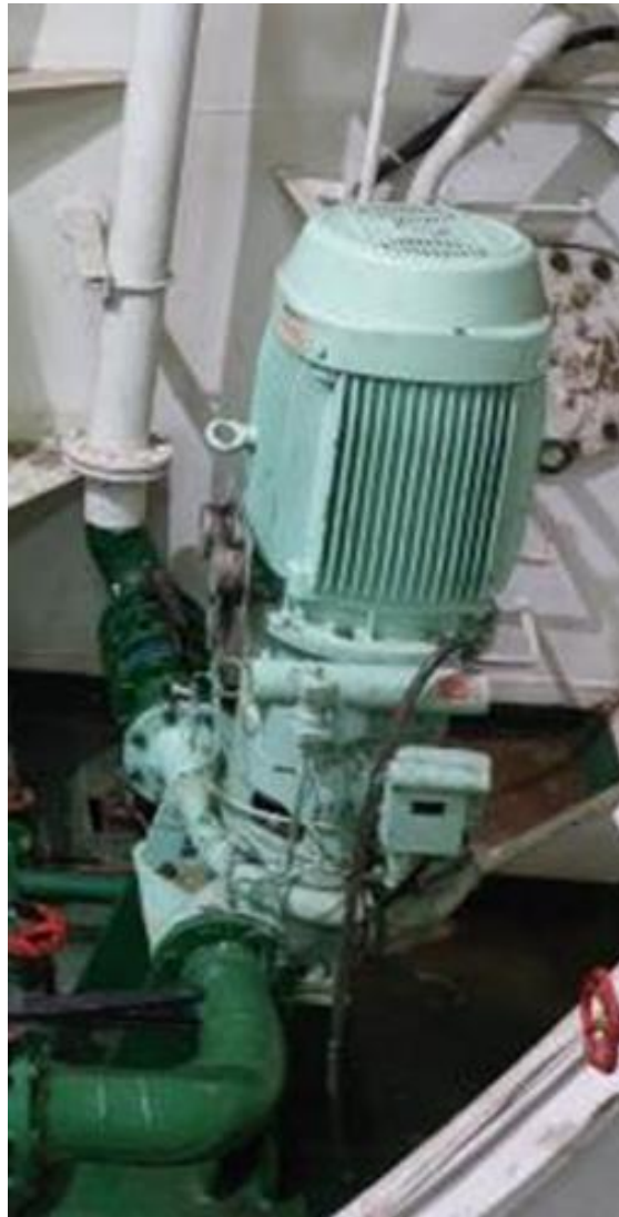
Ilustración 9. Bomba contraincendios principal del buque. Fuente: Elaboración propia.
