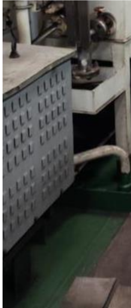
Ilustración 22. Transformador del generador de emergencias ubicado en la sala del generador de emergencias. Fuente: Elaboración propia.
