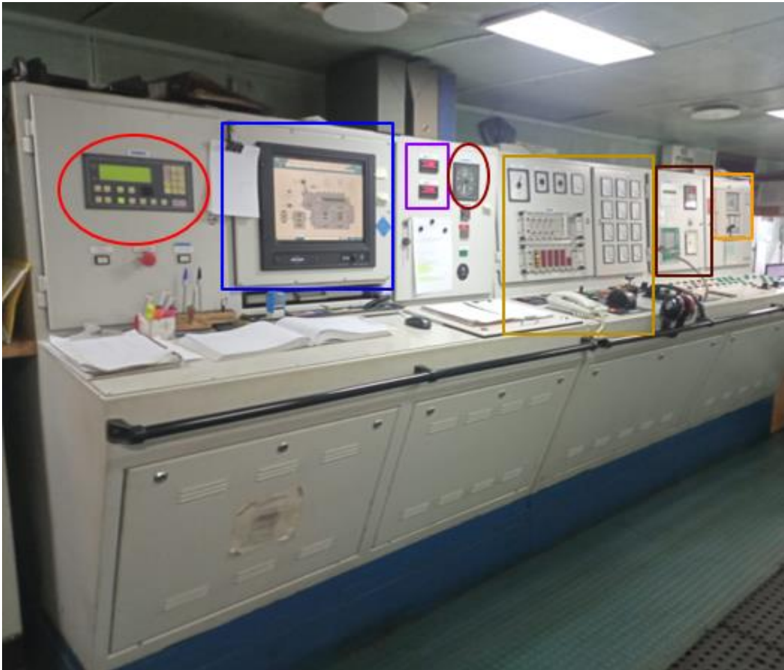
Ilustración 10. Control Room de la sala de máquinas del buque. Fuente: Elaboración propia
