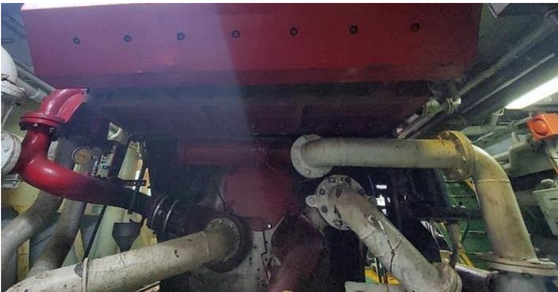
Ilustración 59. Caja de bombas y enfriador de carga. Fuente: Elaboración propia.
