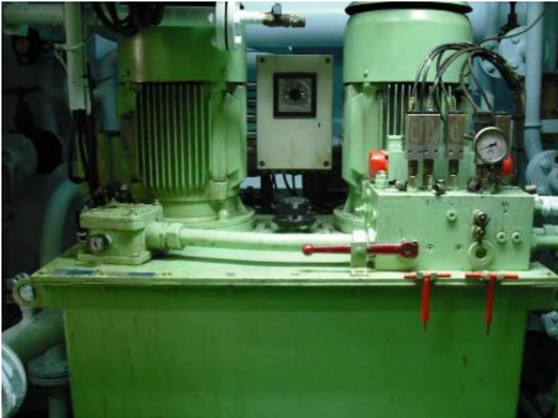
Ilustración 65. Sistema hidráulico de paso variable ubicado en la sala de máquinas (tecle inferior). Fuente: Elaboración propia.
