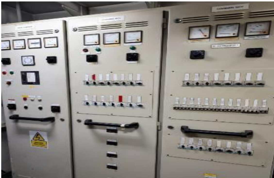
Ilustración 19. Cuadros eléctricos de la sala del generador de emergencias. Fuente: Elaboración propia.
