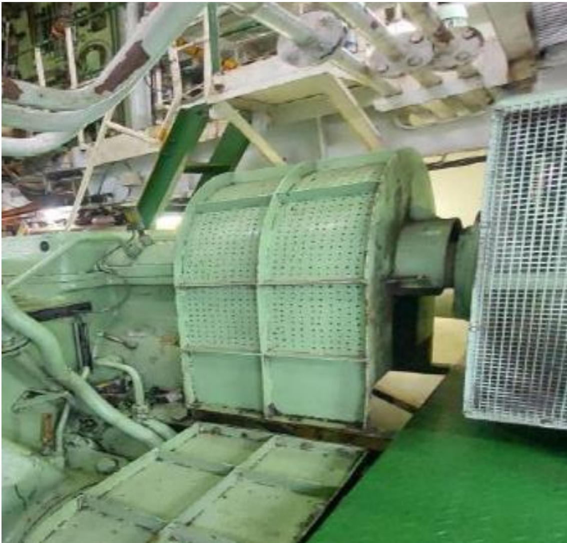
Ilustración 16. Acople del generador de cola con la reductora del motor principal. Fuente: Elaboración propia.
