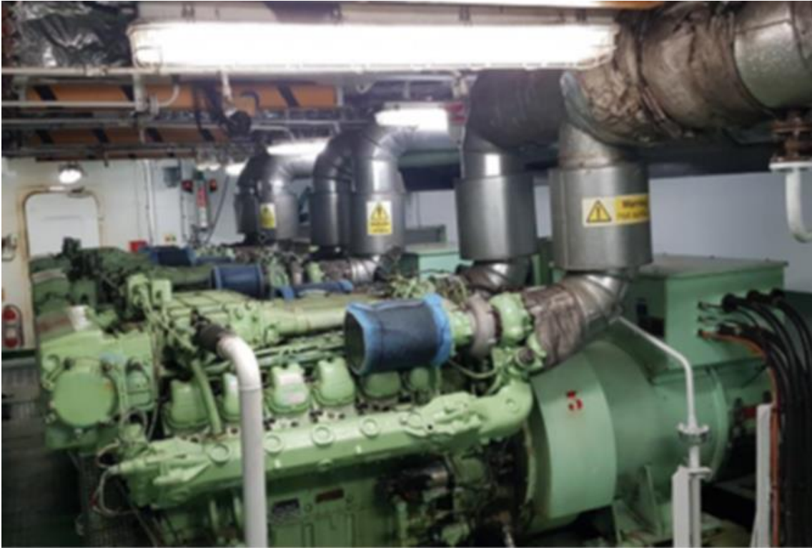
Ilustración 17. Sala de generadores auxiliares. Fuente: Elaboración propia.
