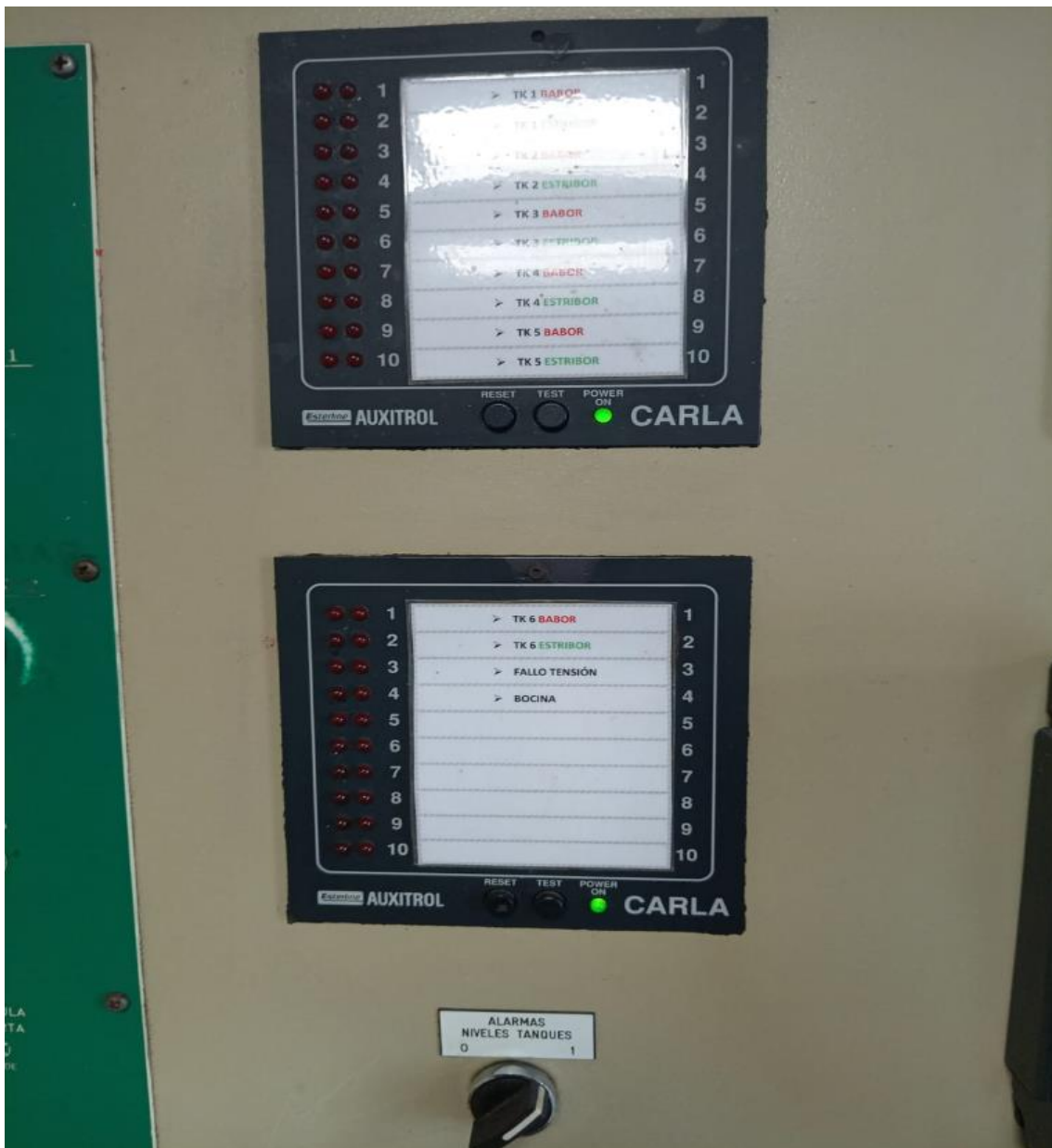
Ilustración 17. Panel de alarma de alto nivel de tanques. Fuente: Trabajo de campo.
