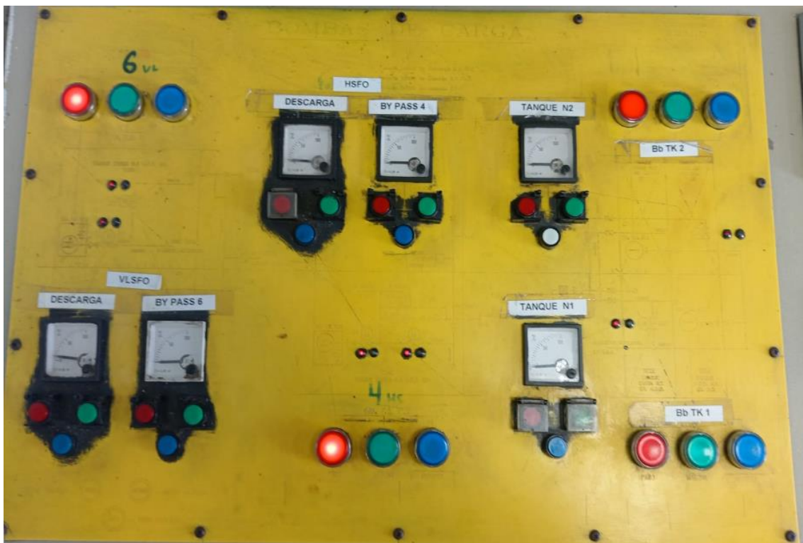
Ilustración 15. Panel de arranque y parada bombas de carga. Fuente: Trabajo de campo.
