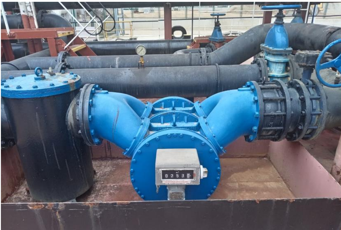
Ilustración 13. Contador volumétrico o flow meter. Fuente: Trabajo de campo.
