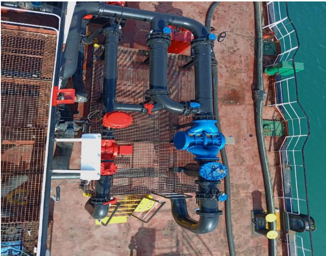
Ilustración 16. Mezclador en la cubierta del barco. Fuente: Trabajo de campo.
