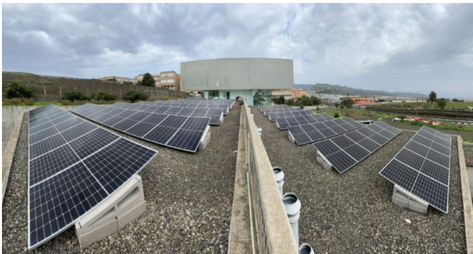
Figura 2.1: Fotografía de la planta fotovoltaica del SEGAI. Fuente: Portal de la Universidad de La Laguna
