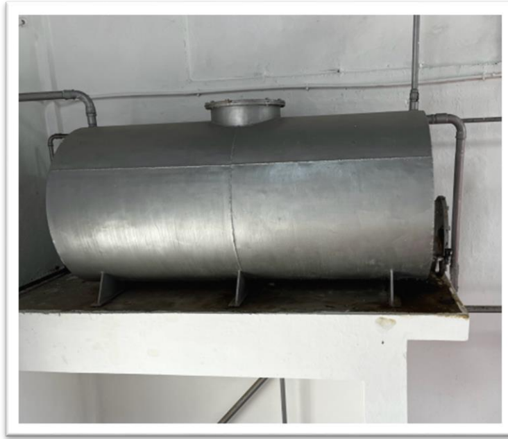
Ilustración 23: Depósito de combustible de alimentación a caldera de 600 litros (Fondo documental de la Destilería de San Bartolomé de Tejina, S.A.).
