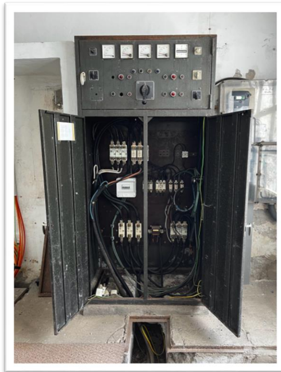
Ilustración 26: Panel de control del grupo electrógeno (Fondo documental de la Destilería de San Bartolomé de Tejina, S.A.).
