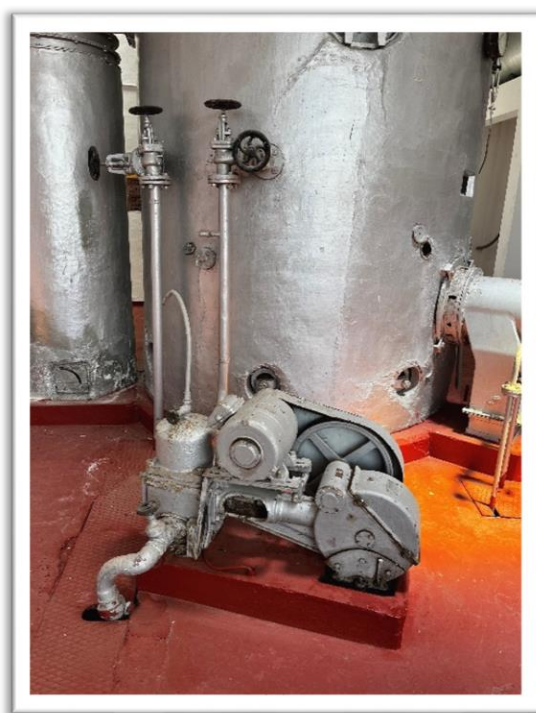
Ilustración 14: Electrobomba de alimentación de agua a caldera (Fondo documental de la Destilería de San Bartolomé de Tejina, S.A.).
