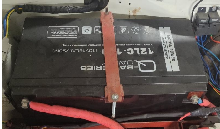
Ilustración 89: Sujeción del sistema de baterías anterior
