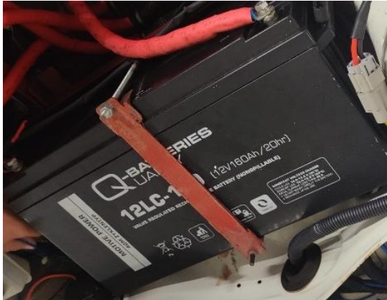
Ilustración 75: Batería de AGM
