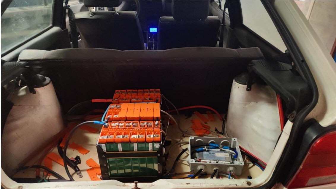
Ilustración 84: Imagen general de la instalación, primeras pruebas de funcionamiento
