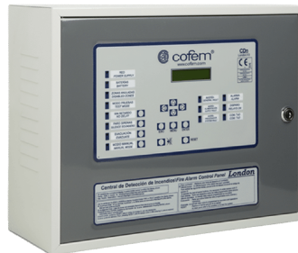
Ilustración 15. Central de detección de incendios
