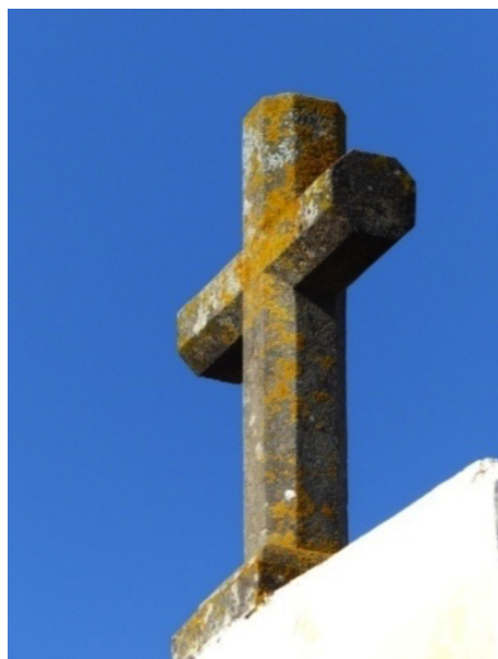
Figura 2.- Portada de la Casa Monteverde. Detalle de la pérdida de material pétreo.
