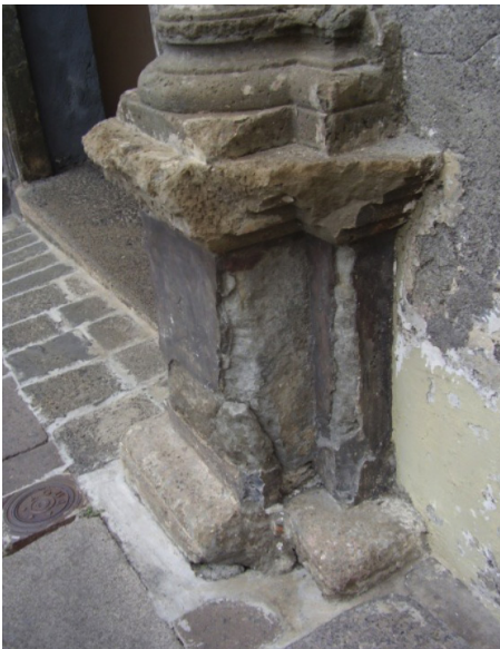
Figura 2.- Portada de la Casa Monteverde. Detalle de la pérdida de material pétreo.
