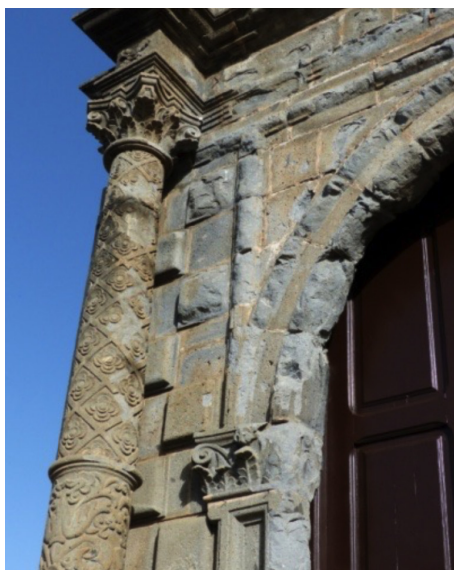
Figura 10.- Portada de la Capilla del Cementerio, antes de la Iglesia del Convento Clariso de San José. Detalle de la afección de la piedra por incendio.
