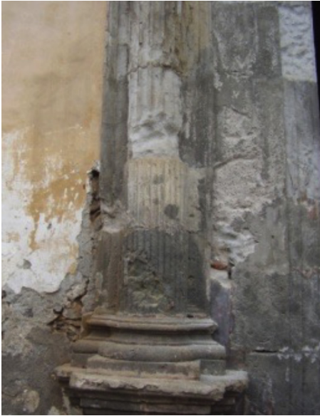
Figura 1.- Portada de la Casa Mesa. Detalle de la pérdida de material pétreo.
