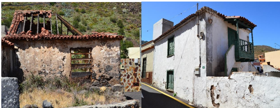
Nº21 y 22. Casas tradicionales deterioradas. Fuente: Elaboración propia
