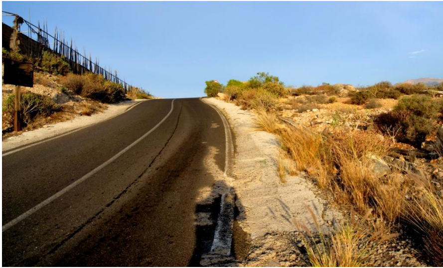
Figura 2: Deficiente estado de la atarjea y del arcén de la carretera.
