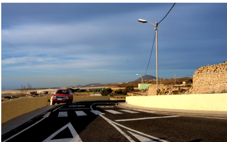
Figura 2: Inicio de la Calle El Llano, en la que se puede apreciar las deficiencias en el acerado.
