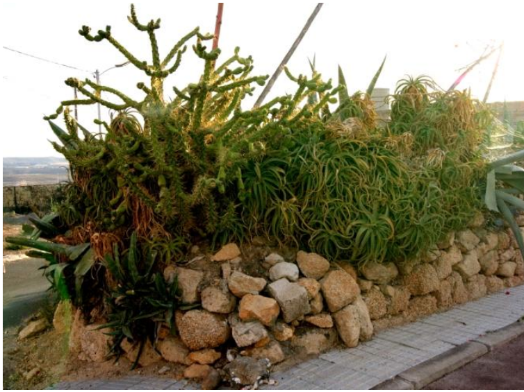
Figura 2: Deficiente estado de la pared de cantos y colonización caótica de la vegetación.
