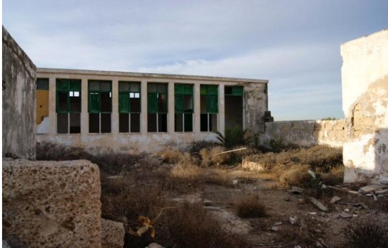
Figura 1: Plano general de la Escuela que muestra su estado de deterioro en su estructura y entorno.
