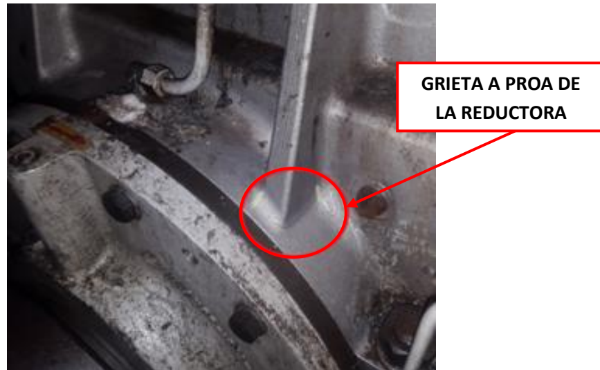
Ilustración n°46. Grieta de proa
