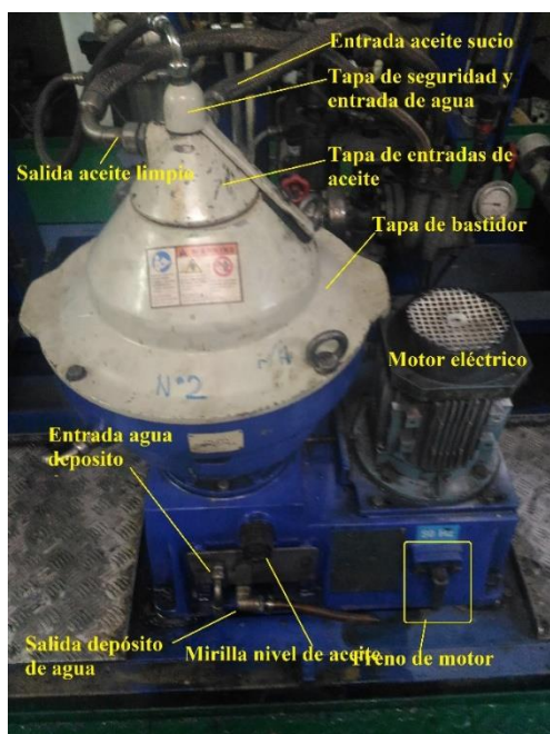
Ilustración 15. Depuradora de aceite 2. Trabajo de campo
