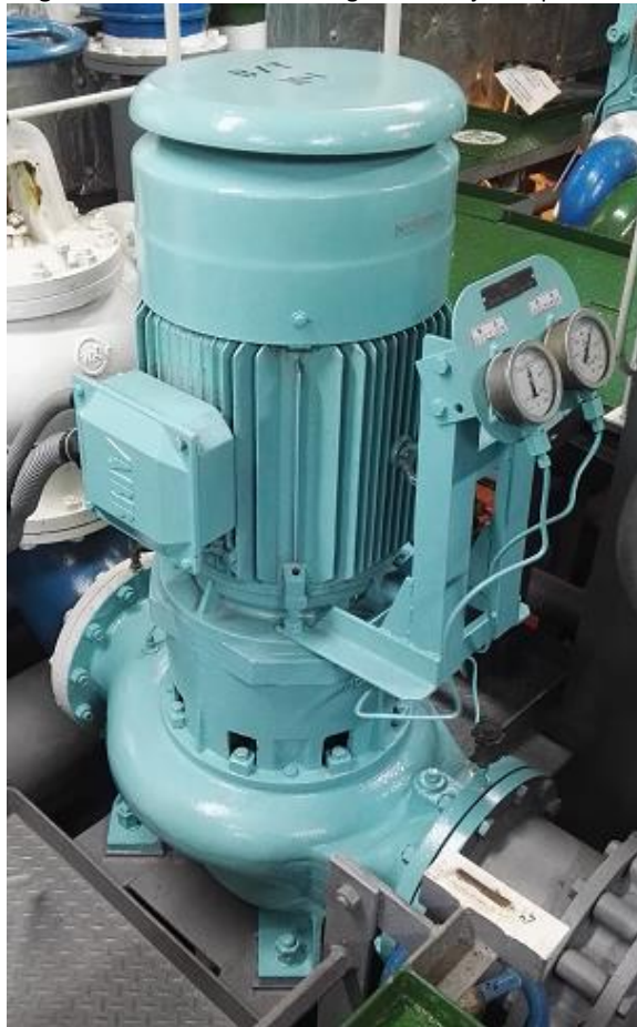
Fig. 45 Bomba circuito de refrigeración baja temperatura
