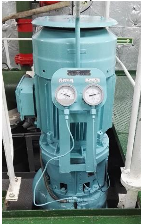
Fig. 46 Bomba sistema agua salada
