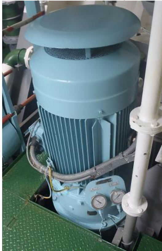
Fig. 49 Bomba limpieza de tanques
