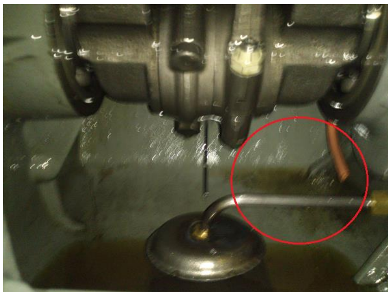
Fig. 70 Suciedad en el interior del cárter
