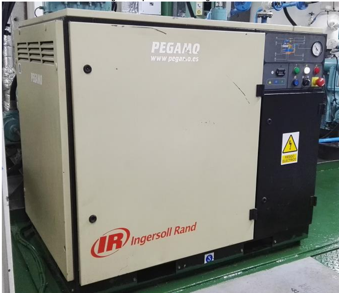
Fig. 14 Compresor aire servicios generales
