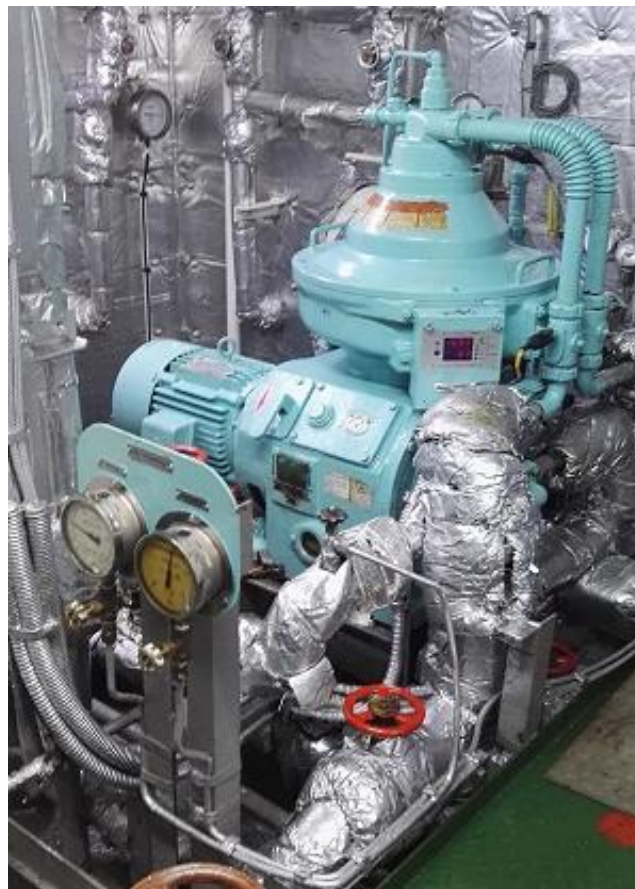
Fig. 77 Depuradora de Fuel
