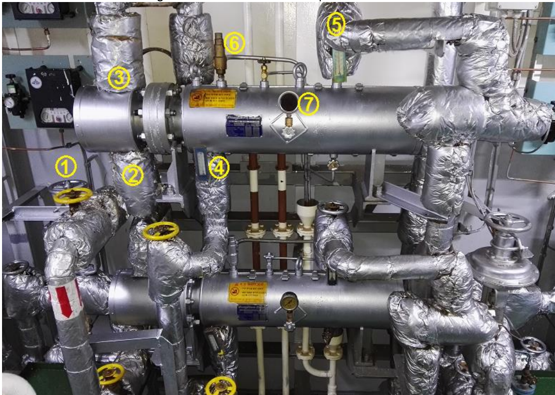
Fig. 29 Intercambiador de calor depuradora de aceite
