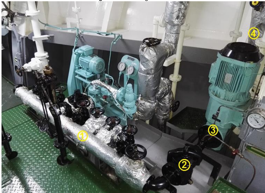
Fig. 57 Bomba trasiego de lodos
