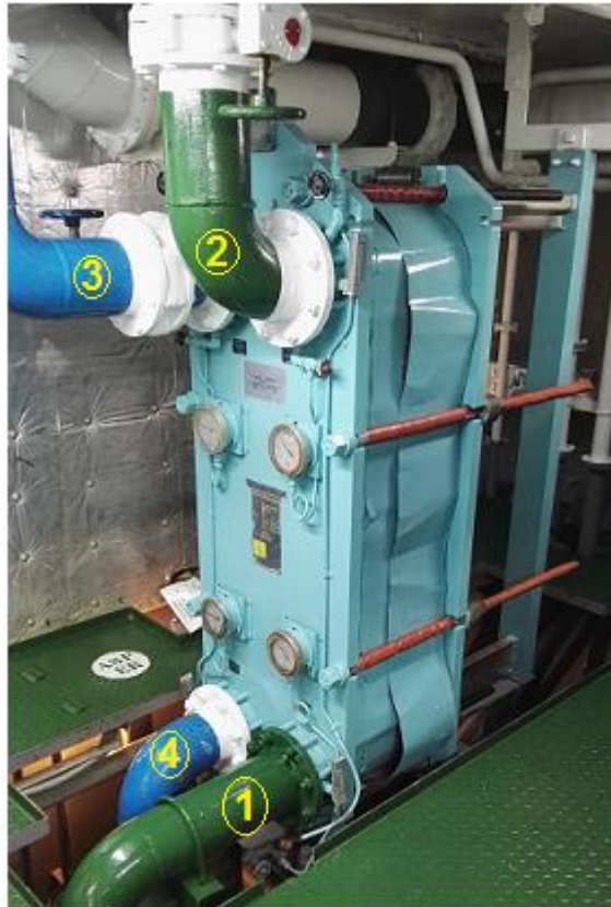
Fig. 44 Enfriador agua de refrigeración circuito de baja temperatura
