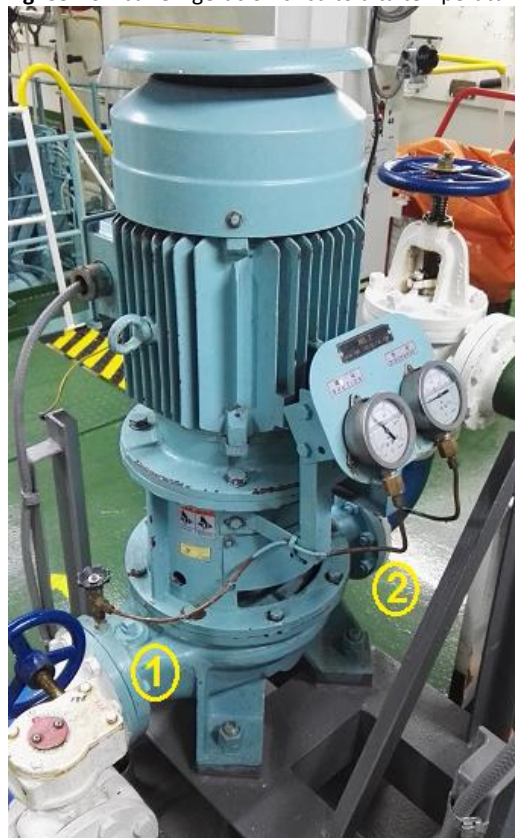
Fig. 39 Bomba refrigeración circuito alta temperatura
