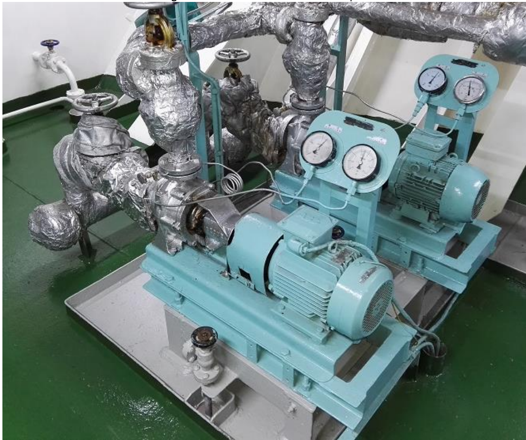
Fig. 20 Bomba circulación caldera de vapor
