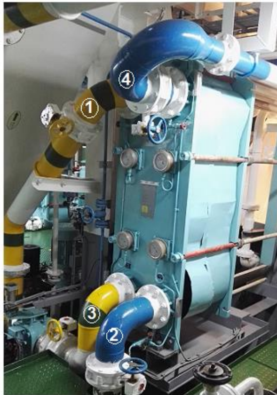
Fig. 52 Enfriador aceite de lubricación del motor principal
