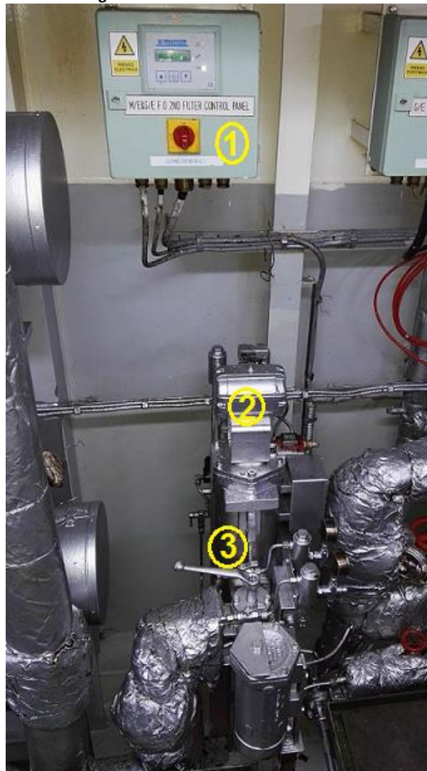
Fig. 32 Filtro automático circuito H.F.O
