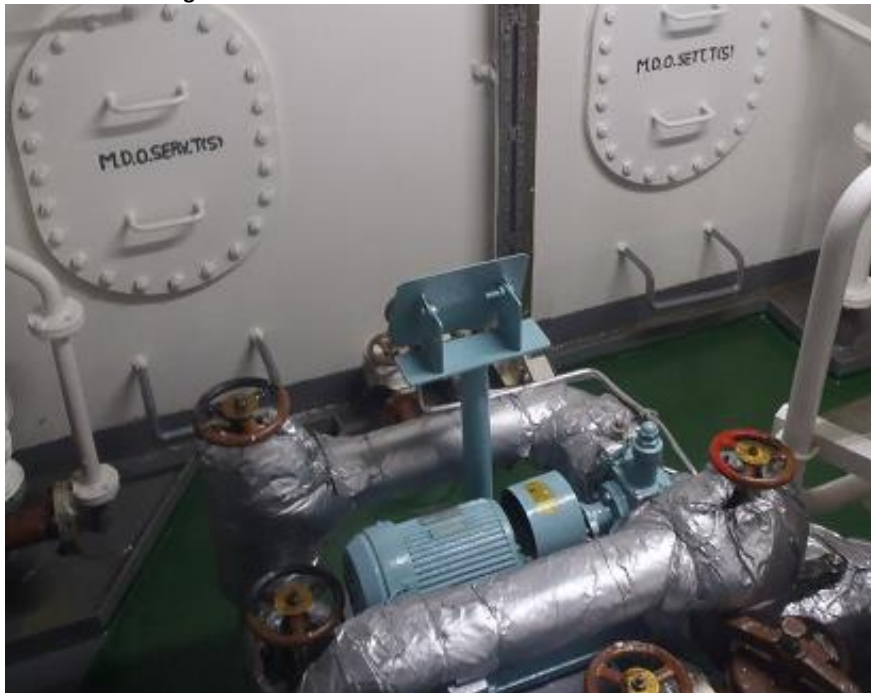
Fig. 23 Bomba alimentación de diésel Motores Auxiliares
