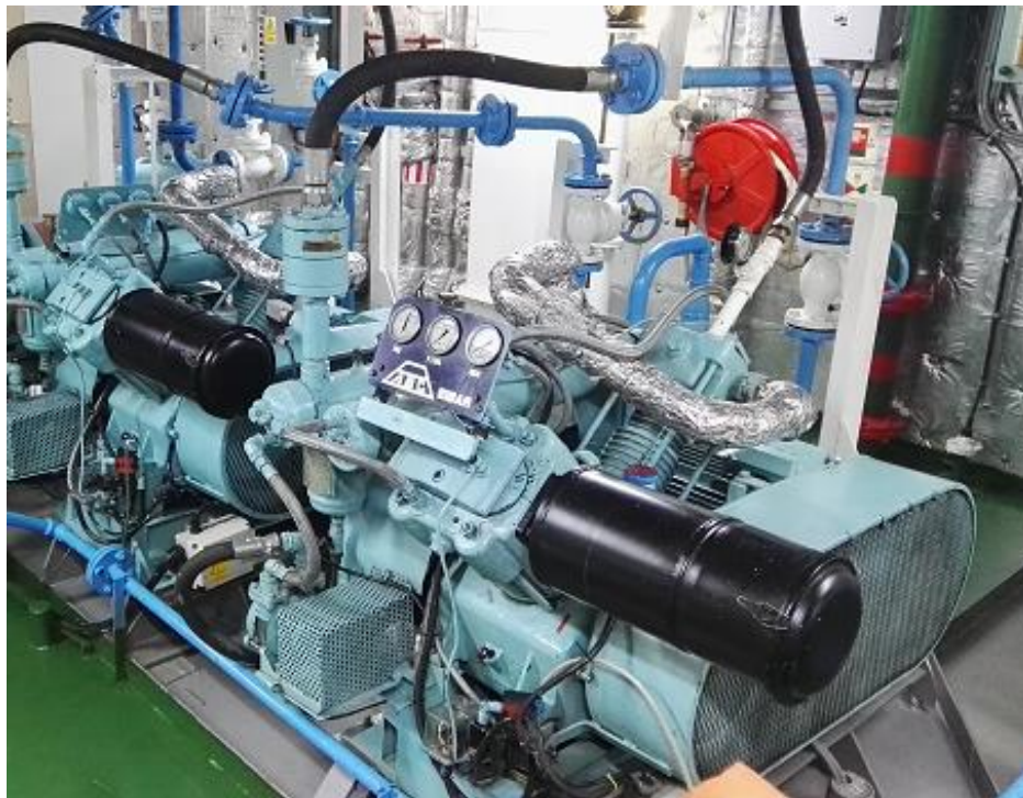
Fig. 68 Compresores de aire de arranque
