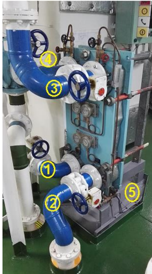
Fig. 35 Enfriador agua de refrigeración alta temperatura
