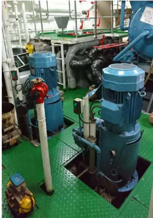
Ilustración 44 Electrobombas de Lastre. Fuente: Trabajo de Campo
