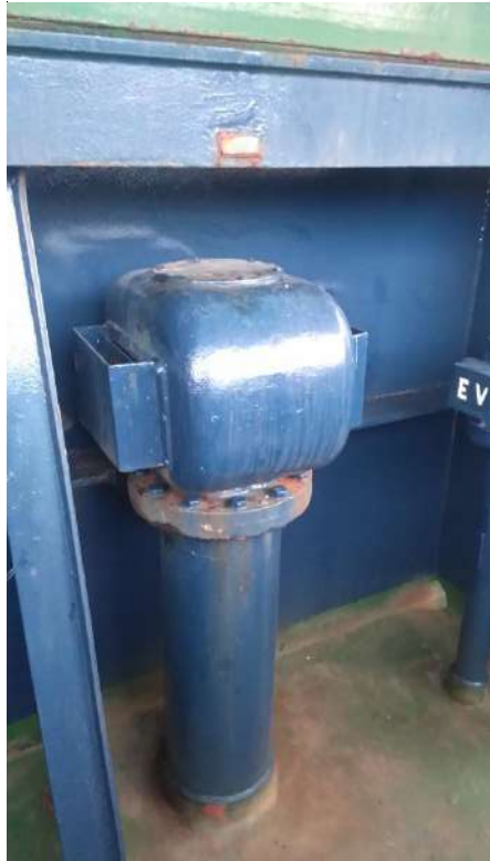
Ilustración 43 Rebose del tanque 5 de lastre Fuente: Trabajo de Campo
