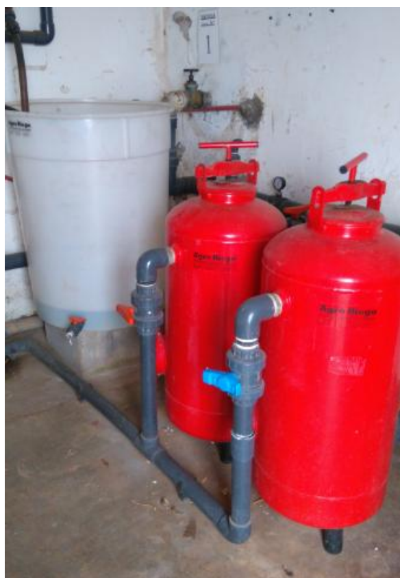
Foto 4.16. Llave principal + filtros de arena.
