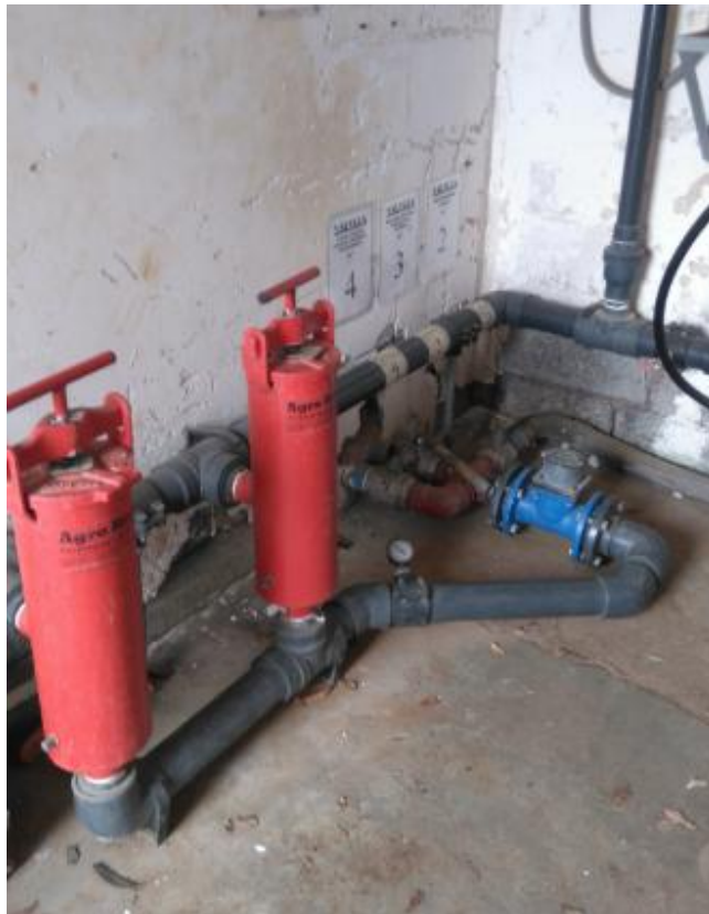
Foto 4.17. Filtros de malla + llave válvulas.
