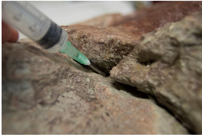
Figura 78. Consolidación de la grieta.
