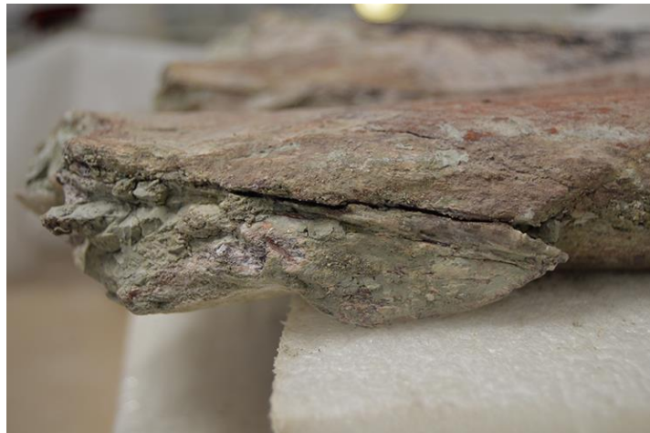
Figura 69. Grieta producida por formación yesífera.
