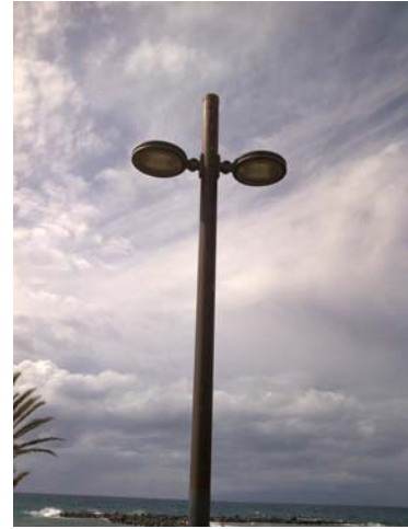
▲ Figura 5.59: Detalle farola de dos focos
