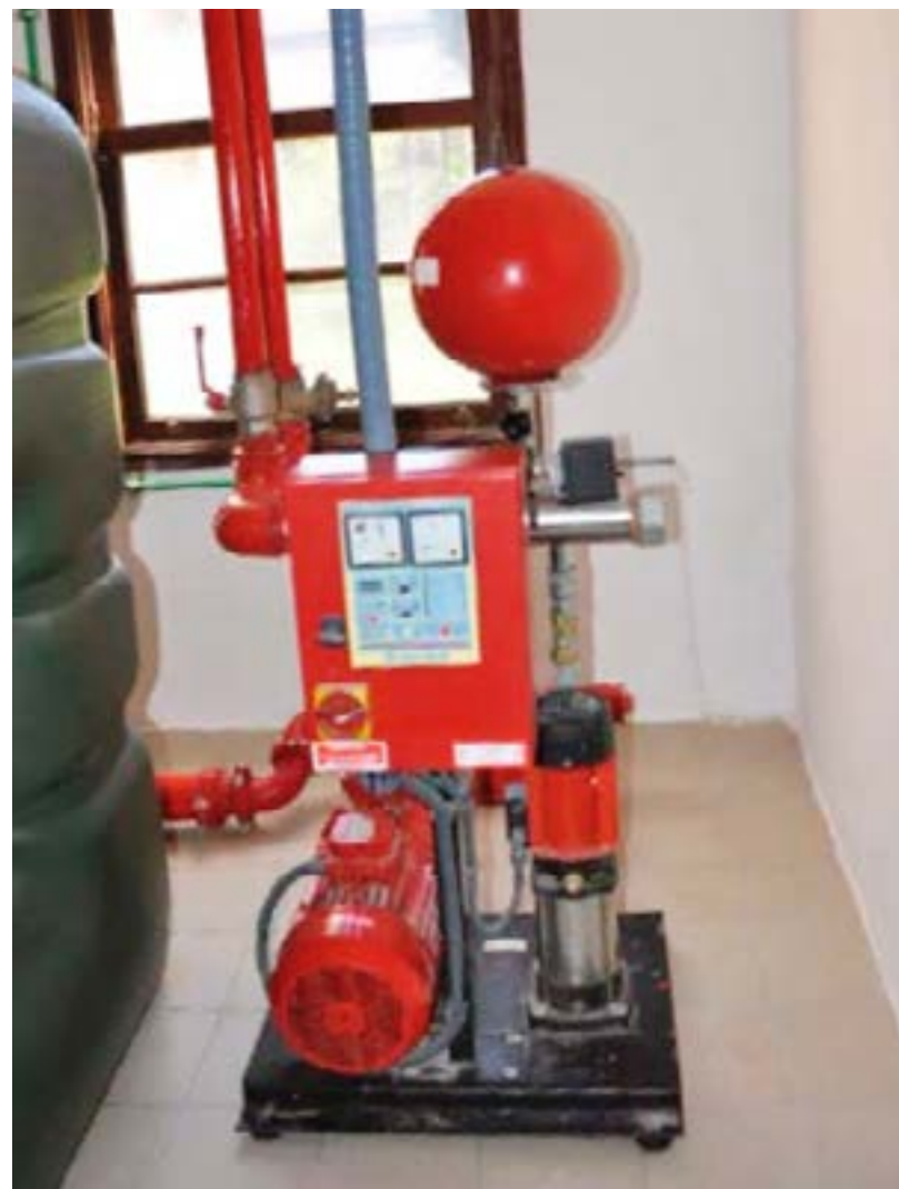
Sala de protección contraincendios en Viana, 50
