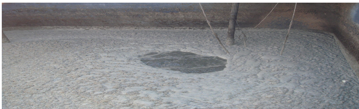
Imagen 4. Balsa estación de tratamiento en funcionamiento. Fuente: Elaboración propia.
