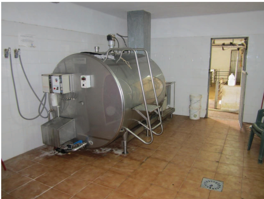
Foto 25: Zona de refrigeración
