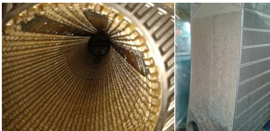
Ilustraciones 40 y 41: Enfriador de agua de baja temperatura limpio Fuente: Trabajo de campo
