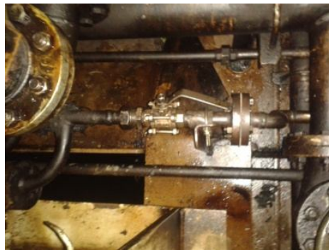
Ilustración 80: Válvula entrada combustible motor auxiliar. Fuente: Trabajo de campo
