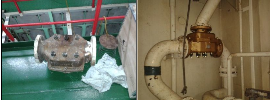
Ilustraciones 78 y 79: Válvula termostática usada y válvula termostática nueva. Fuente: Trabajo de campo
