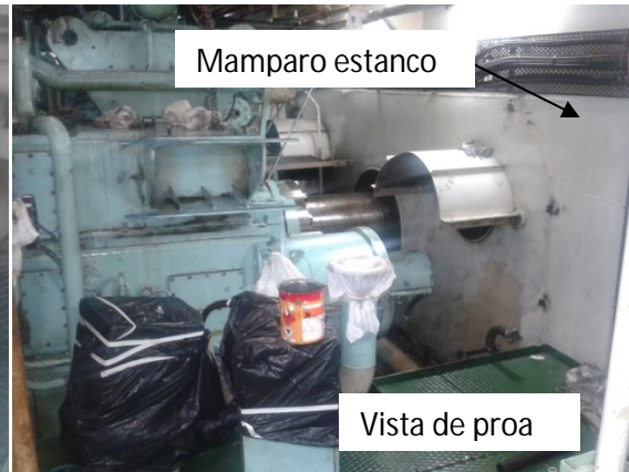
Ilustración 7: Reductora motor principal Fuente: Trabajo de campo
