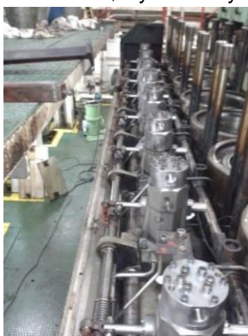
Ilustración 122: Vista bombas de combustible motor principal Fuente: Trabajo de campo
