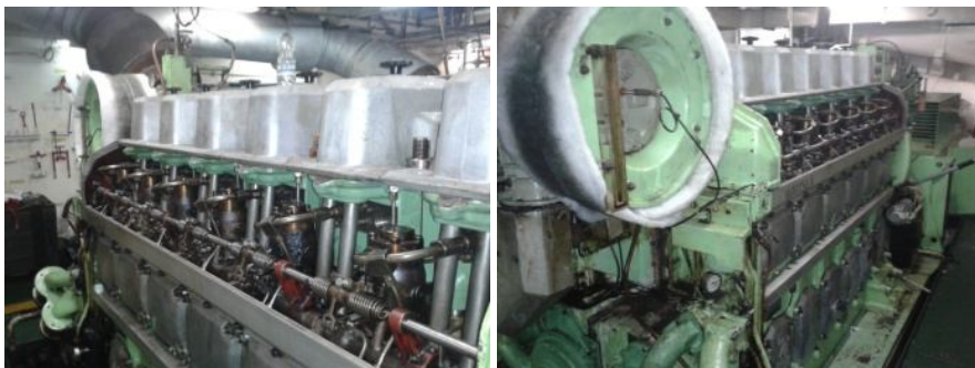
Ilustraciones 100 y 101: Vista de motores auxiliares ya reacondicionados Fuente: Trabajo de campo
