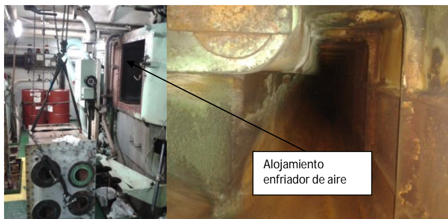
Ilustraciones 34 y 35: Enfriador de aire y colector Fuente: Trabajo de campo
