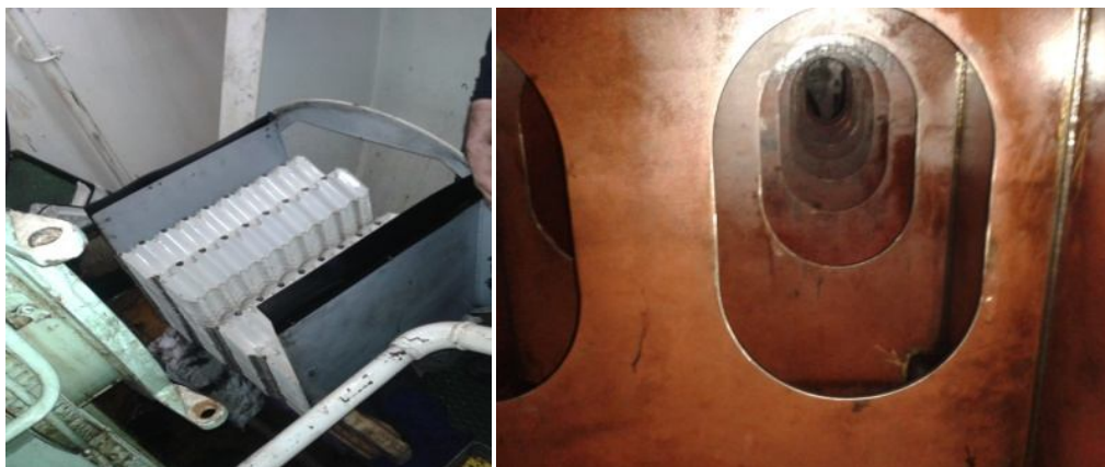
Ilustraciones 72 y 73: Separador de sentinas y tanque almacén de aceite de uno de los motores principales. Fuente: Trabajo de campo
