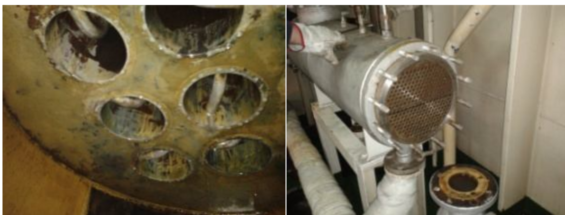
Ilustraciones 112 y 113: Hogar tras la limpieza y condensador Fuente: Trabajo de campo
