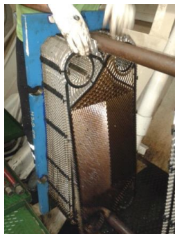
Ilustración 26: intercambiador de calor circuito de aceite de un motor principal Fuente: Trabajo de campo
