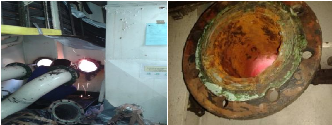
Ilustraciones 54 y 55: Descarga al mar del colector de agua de mar y carrete oxidado Fuente: Trabajo de campo
