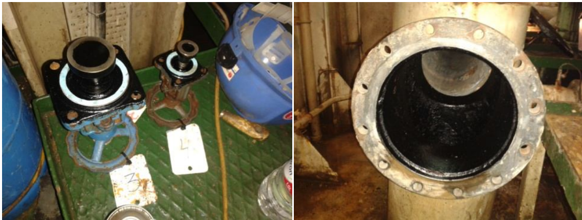
Ilustraciones 70 y 71: Válvulas y colectores de agua de mar reacondicionados Fuente: Trabajo de campo
