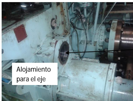
Ilustración 8: Reductora Fuente: Trabajo de campo
