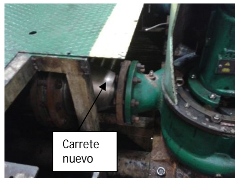
Ilustración 29: Bomba agua de mar, circuito refrigeración Fuente: Trabajo de campo
