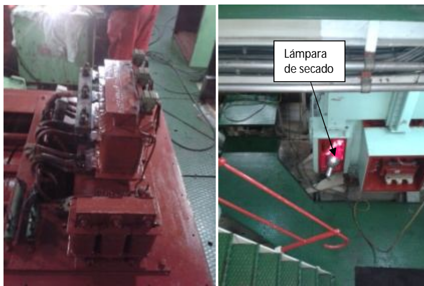
Ilustraciones 97 y 98: Conexiones alternador de cola y vista de un alternador de cola barnizado Fuente: Trabajo de campo
