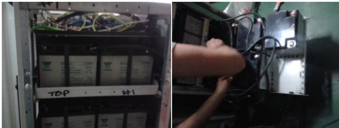
Ilustraciones 92 y 93: Baterías Fuente: Trabajo de campo
