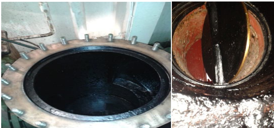
Ilustraciones 56 y 57: Filtro colector de agua de mar y válvula fondo de agua de mar Fuente: Trabajo de campo
