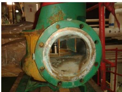
Ilustración 24: Bomba agua de mar, circuito refrigeración Fuente: Trabajo de campo
