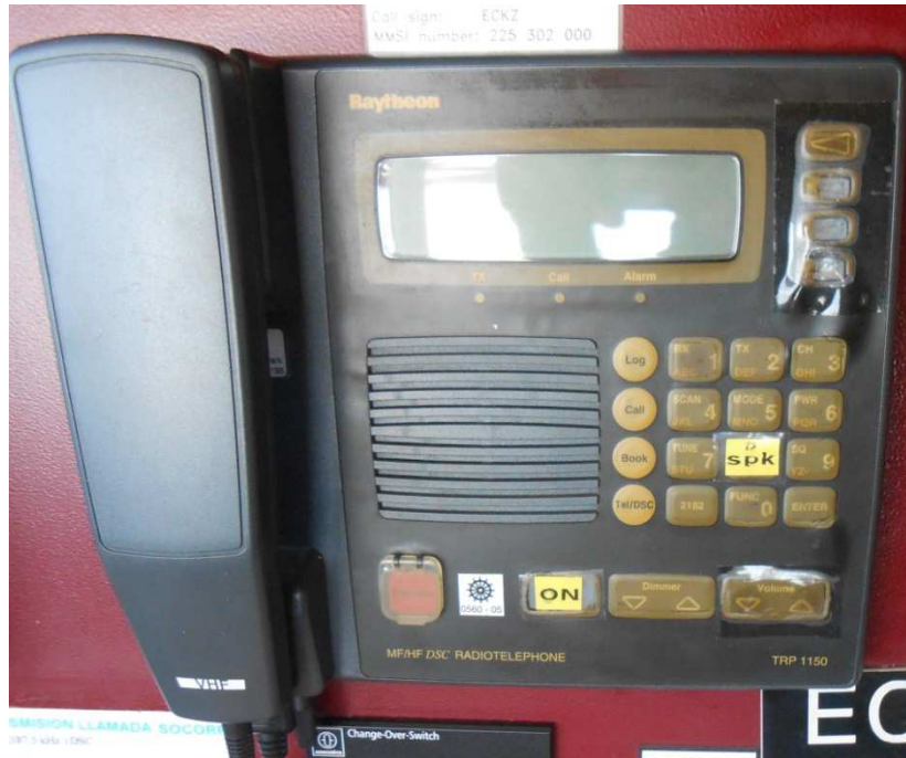
Ilustración 52. Equipo MF/HF TRP1150 Raytheon Anschütz Fuente: Trabajo de campo
