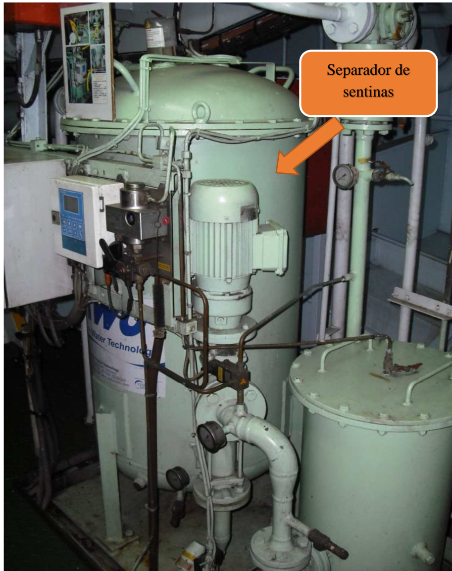
Figura 34 - Vista de conjunto del separador de sentinas.
