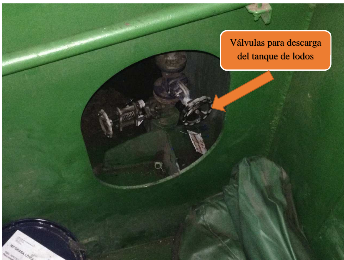
Figura 55 - Detalle de las válvulas para descarga a tierra, bajo el tanque de lodos.
