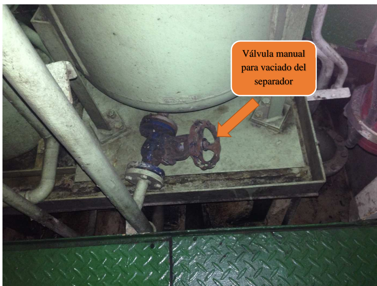
Figura 51 - Detalle de la válvula manual para descarga del separador al tanque de sentina.
