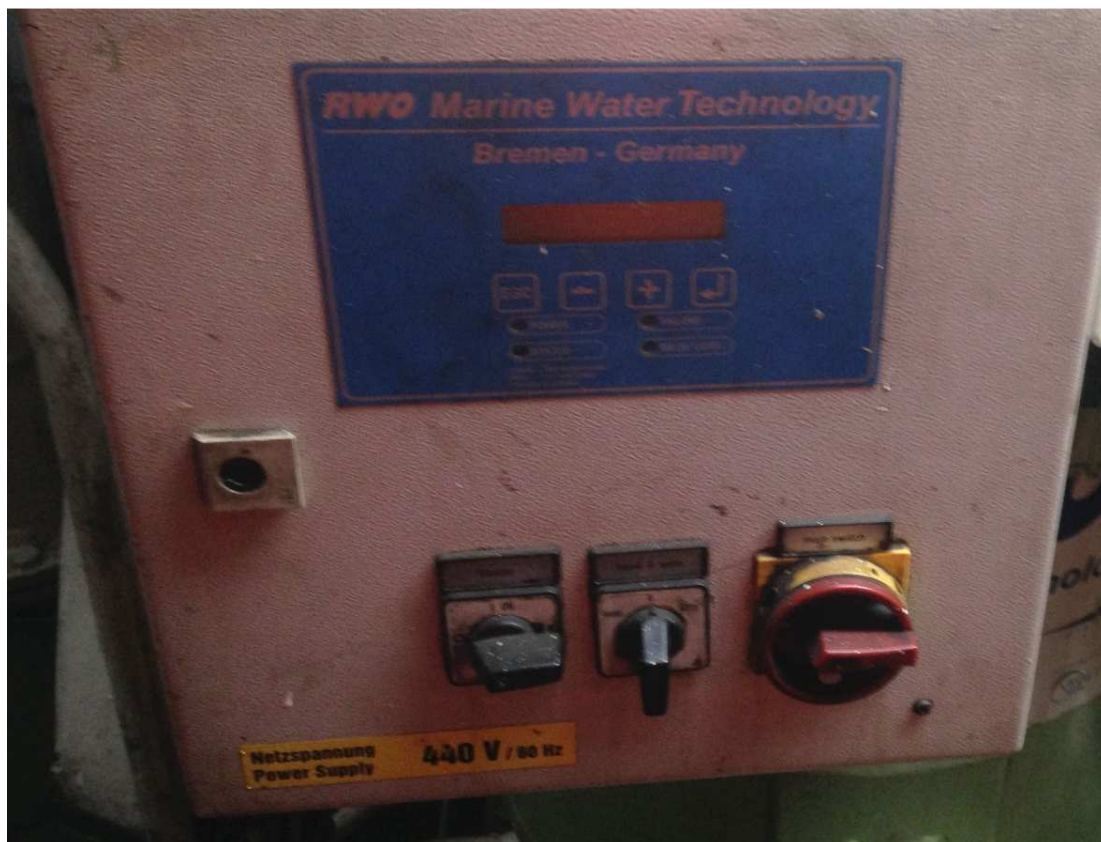
Figura 40 - Módulo de control del separador.
