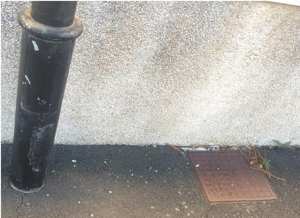
Ilustración 14. Arqueta y base de luminaria de Física.
