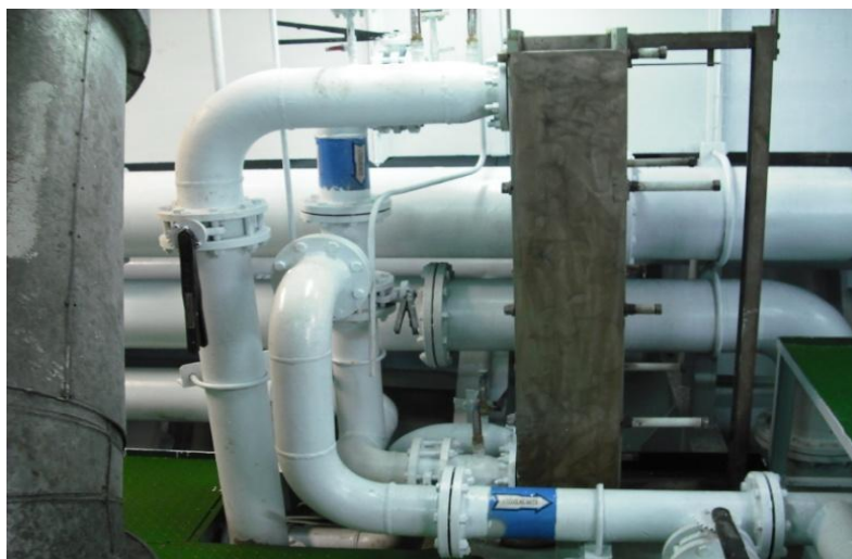
Ilustración nº16: Enfriador alta temperatura
