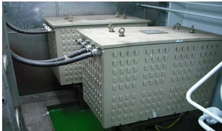
Ilustración nº15: Transformadores Cuadro Eléctrico principal
