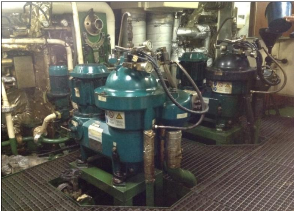
Ilustración nº 18: Depuradoras de Combustible
