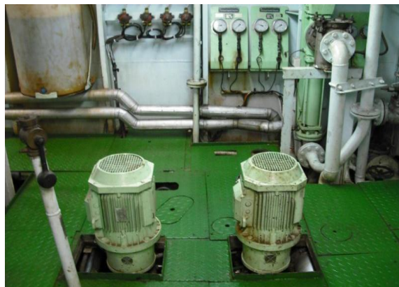
Ilustración n º17: Bomba de trasiego del combustible
