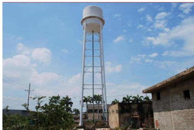
Figura 14. Tanque de agua potable elevado en Paraguay.
